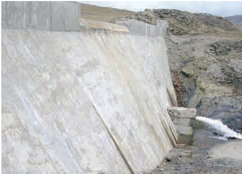
Vista del cuerpo, vertedor y obra de toma de la presa aguas abajo. No se observa el colchón amortiguador.
