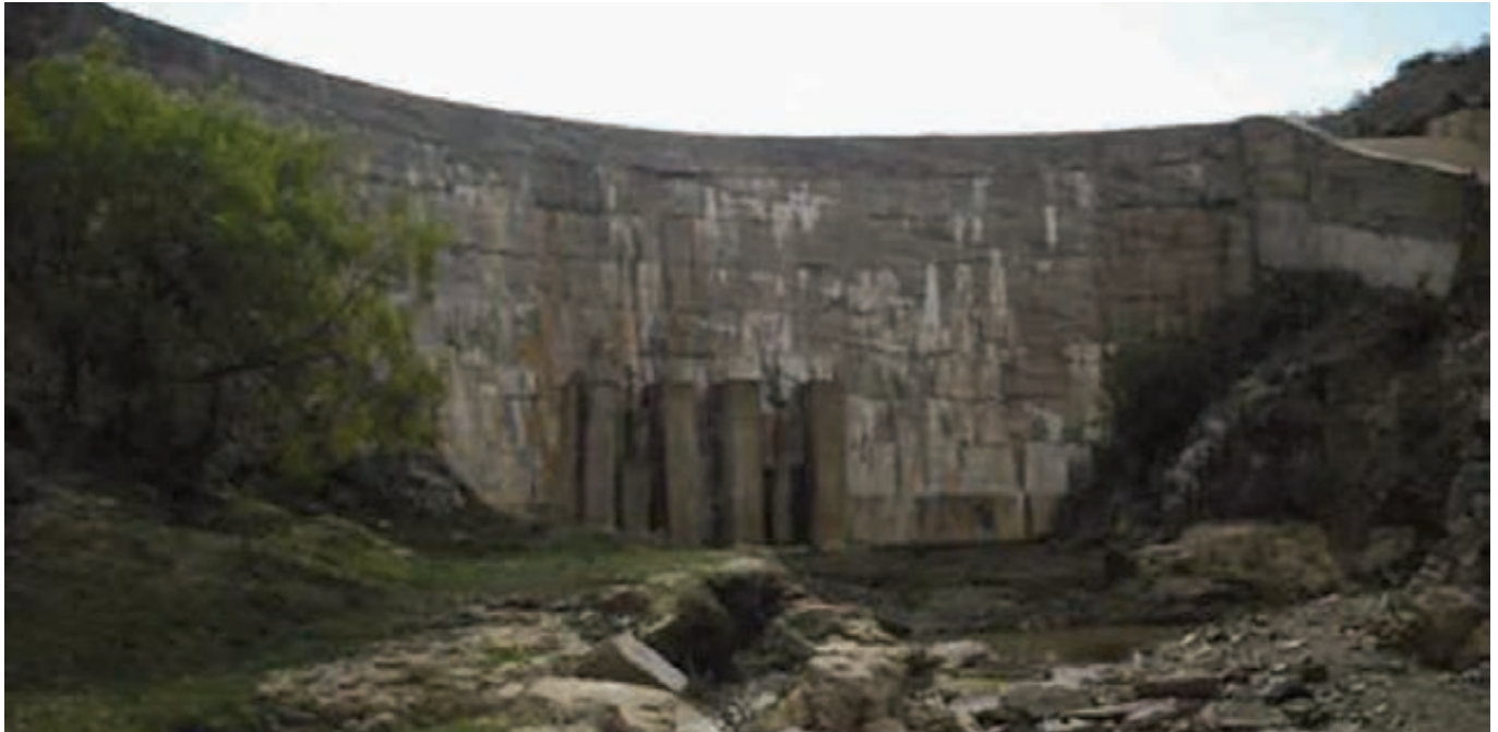
Vista aguas abajo de la presa ,vertedor de excedencias y compuertas de desfogue de fondo
