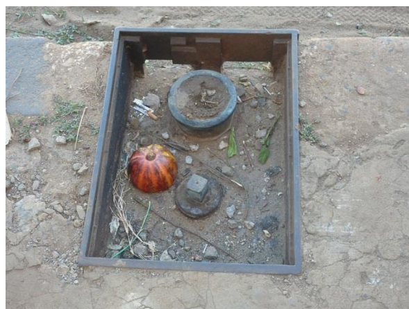
PHOTO 5 : EQUIPEMENTS A REMPLACER
