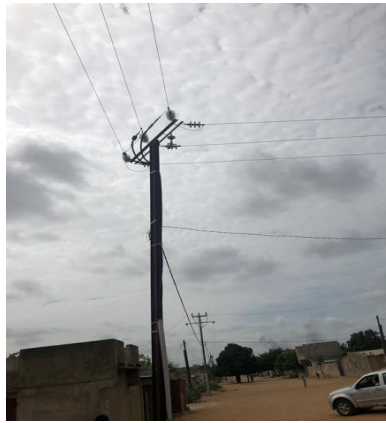
Photo 4 : Départ vers le poste Mbour extension 3
