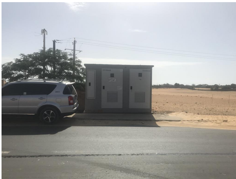
Photo 11 : Exemple d'un poste préfabriqué (Source : photo de terrain, mars 2019)
