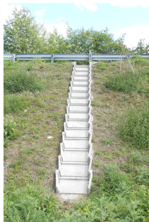
Descente d'eau « grand débit »
