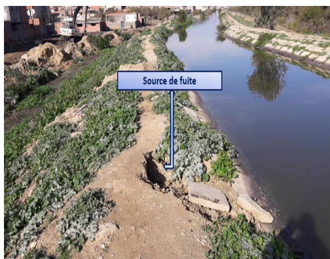
Figure 20: Fuite des EUE au niveau provenant du canal
