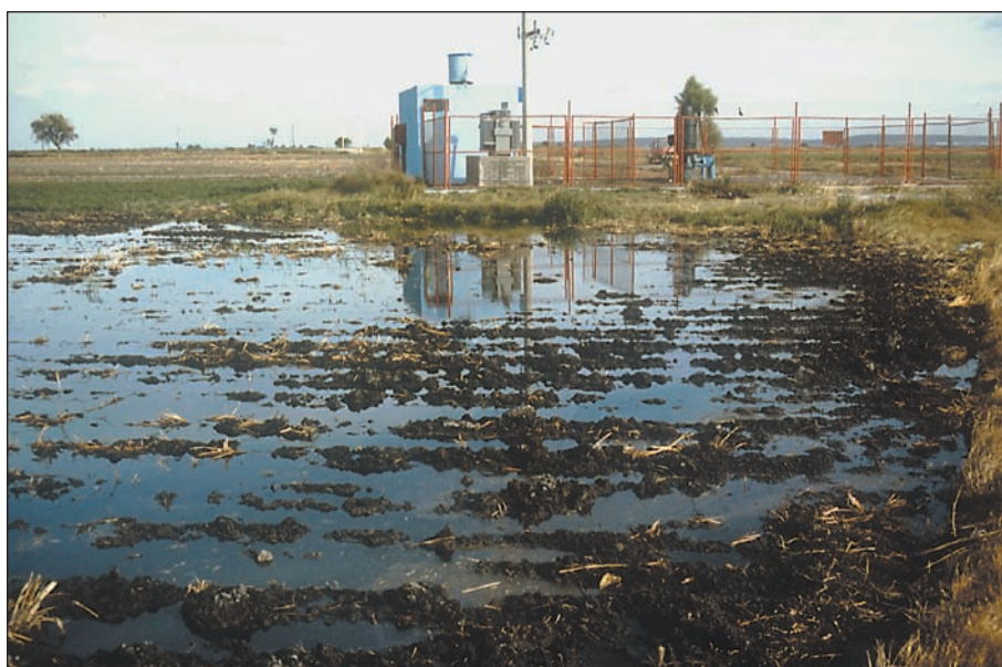
b) zona operacional mal dimensionada e com proteção inadequada, ameaçada por irrigação agrícola com águas residuais urbanas
