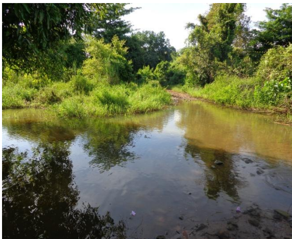
Photo 3 : Radier inondé en permanence
