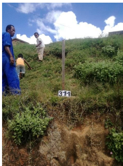
PHOTO 3 : SITE SENSIBLE À L'ÉROSION (AVARATSENA, SOAVINANDRIANA)
