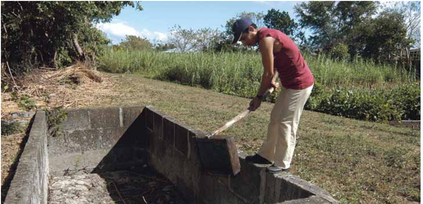
Operador vertiendo sólidos del canal de entrada en desecador de lodos
