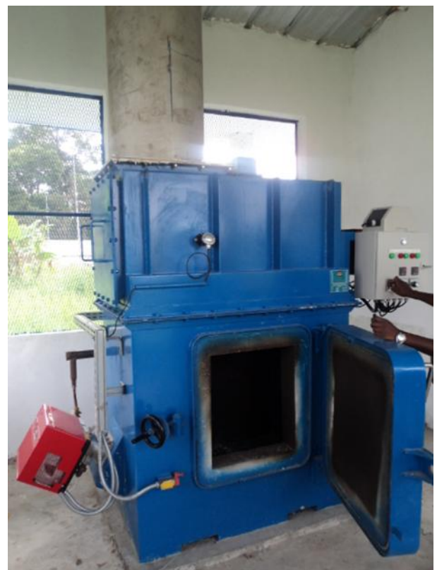
Incinérateur moderne à combustion pyrolytique de déchets sanitaires
