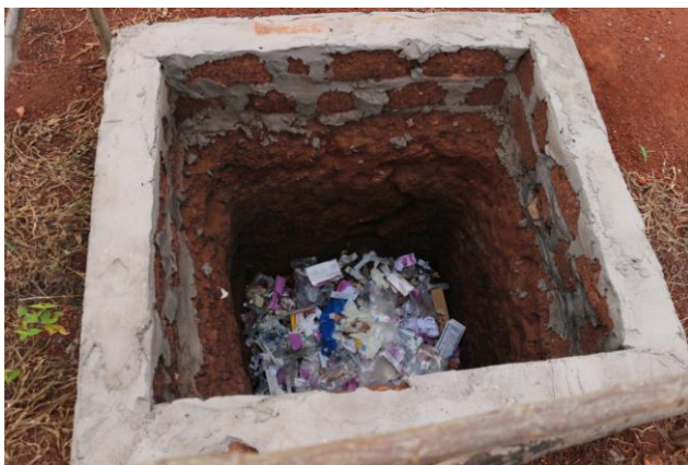
Fosse à déchets sanitaires non sécurisées
