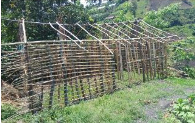
Photo 7 : Une cabane en cours de construction par le PA à Kalungu dans le Sud Kivu Sources E. TOKOROKOU et N. TRESOR Septembre 2018
