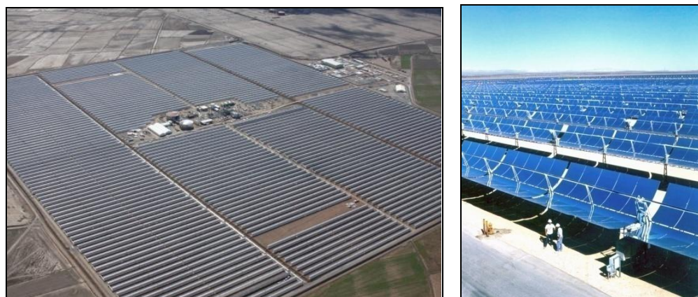
Figures 22 : Exemple de centrales à capteurs cylindro-paraboliques : Andasol 1 – Espagne (à gauche) et Solar Electric Generating Station VI – Etats-Unis (à droite)
