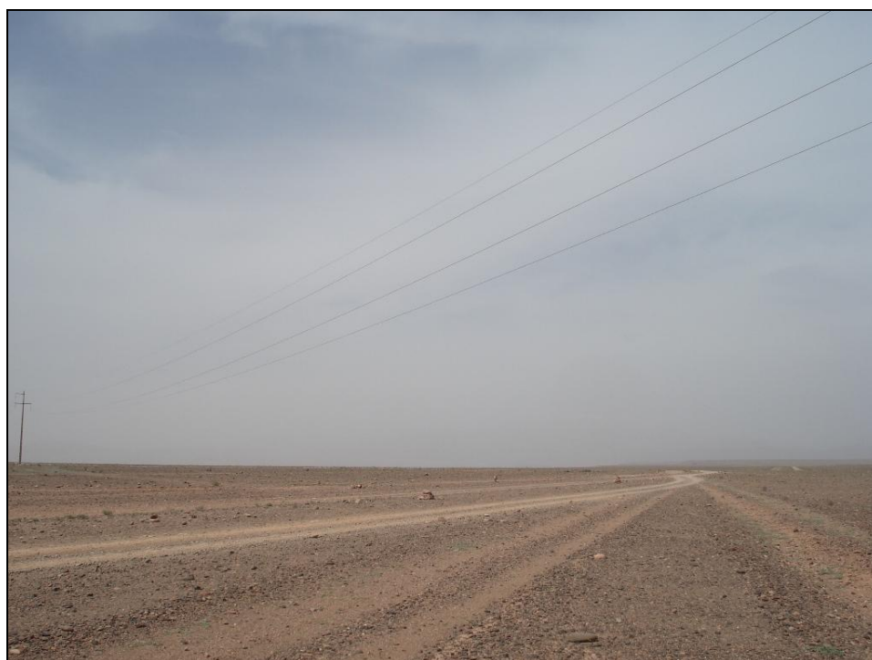
Photo 17 : Ligne électrique de 60 kV traversant le site du complexe solaire d'Ouarzazate
