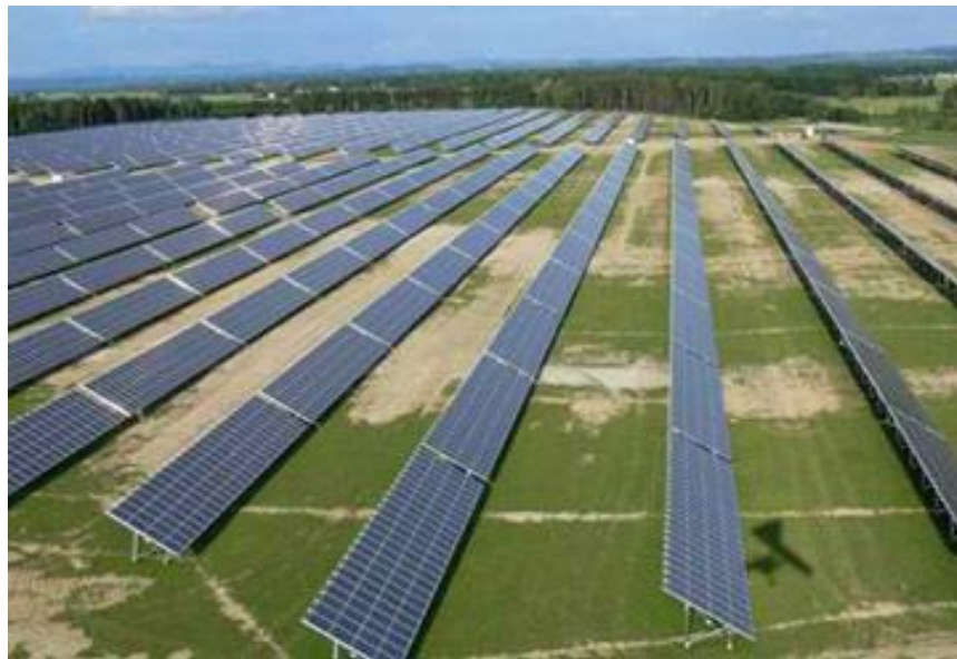
Figure 18 : panneaux photovoltaïques fixes
