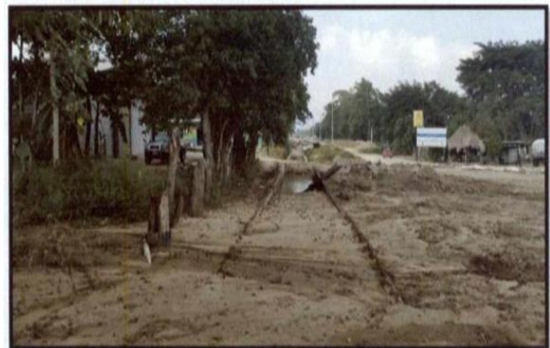
Photo 2. Sediment deposit after Hurricanes Eta and Iota in the Project Area. Source: Canalización de Aguas Pluviales de la Colonia Rosario Nuñez para Reducir el riesgo de la quebrada Jocomico del municipio de El Negrito
