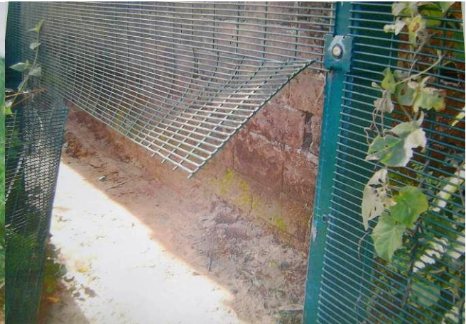
Grillage de la clôture sectionnée
