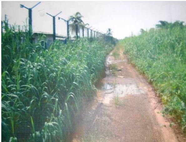
Piste de patrouille accolée à la clôture de sécurité- envahissement par les hautes herbes
