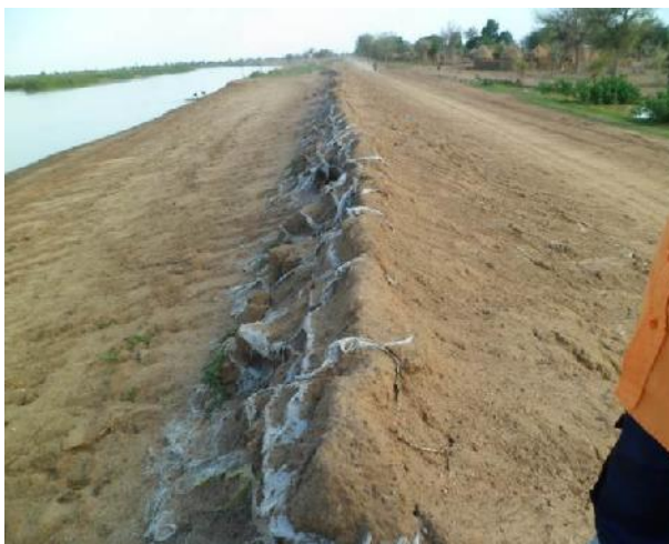
Figure 16: Digue rehaussée par les sacs de terre déjà dégradés au niveau de Doréïssou
