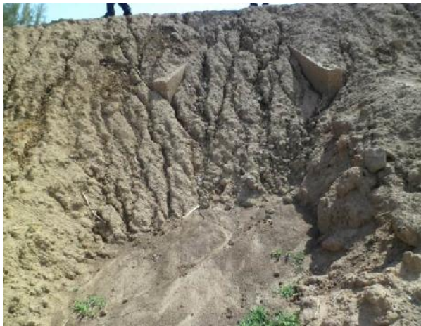
Figure 14: Canal de Begué Palam actuellement bouché
