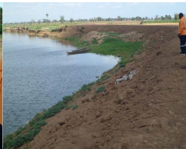
Figure 17: Pied de la digue complètement sur le bord du Logone
