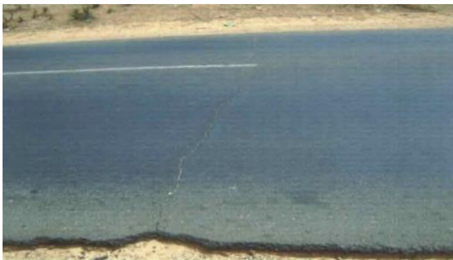
PHOTO 8 : FISSURES TRANSVERSALES AFFECTANT TOUTE LA LARGEUR DE CHAUSSEE (RN7)
