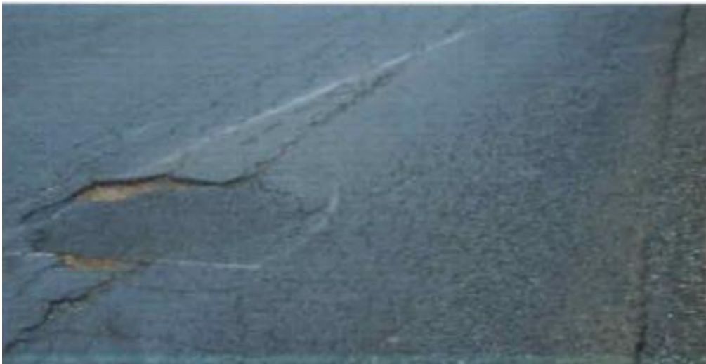
PHOTO 10 : RESEAU DE FISSURES LONGITUDINALES RN4
