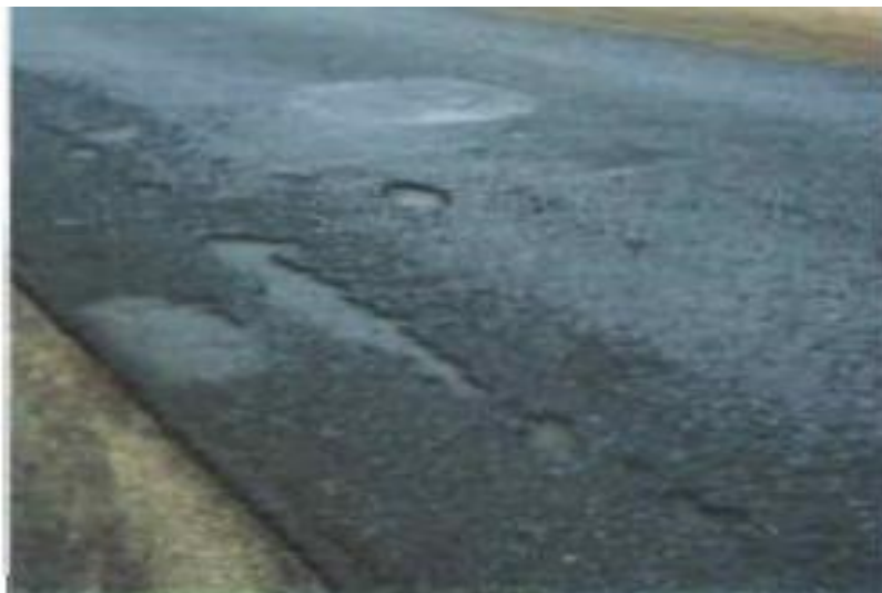
PHOTO 13 : RESEAU DE PLUMAGE (RN2)
