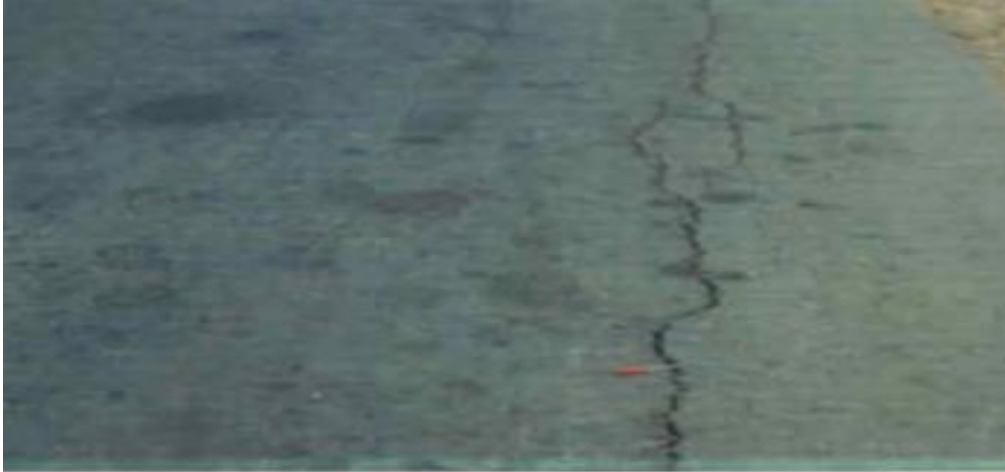
PHOTO 9 : FISSURES LONGITUDINALES AVEC OUVERTURE FRANCHE RN2
