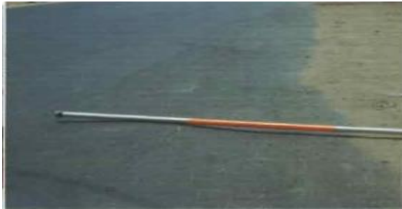
PHOTO 7 : BOURRELETS MIS EN RELIEF PAR LA SURELEVATION DU JALON (RN2)
