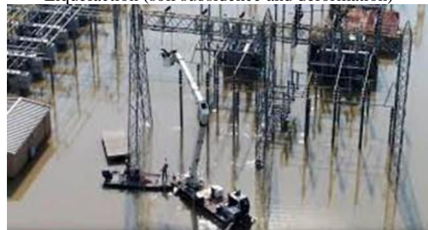
Flood (substation inundation)
