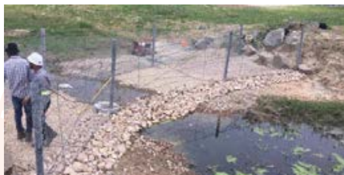
Figura 1 Sistema de retenção de plástico do escoadouro Baia, na provincial de Maputo
