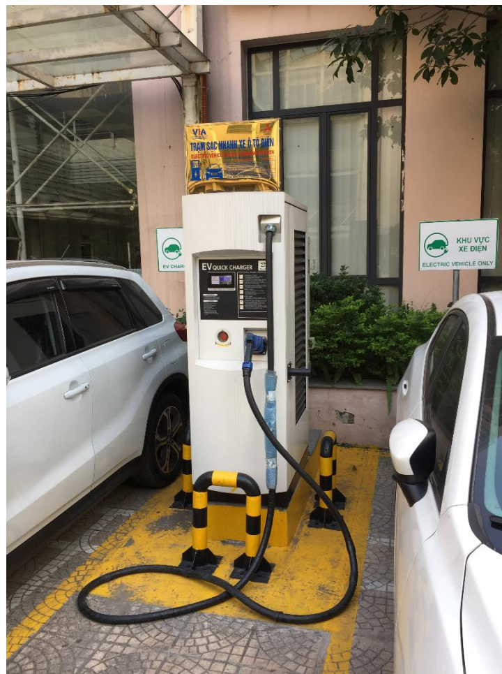
Hình 6.1. Bộ sạc nhanh lắp đặt tại tòa nhà Bộ Công Thương tại Hà Nội
