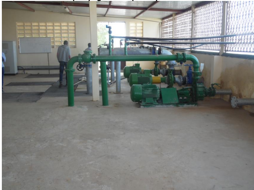
Photo 5 : Station de pompage électrique du périmètre horticole de SERIC
