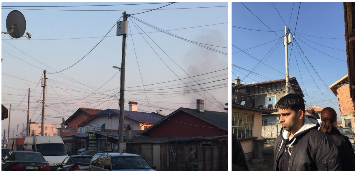
Снимка 8.2: Индивидуални електромери поставени на високо на електрическите стълбове
