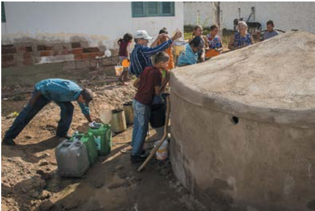
Foto 4 – Uma cisterna instalada na sede municipal melhora o acesso à água. Crédito: Dorte Verner.
