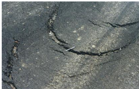
Figura 30. Aderență scăzută între straturi
