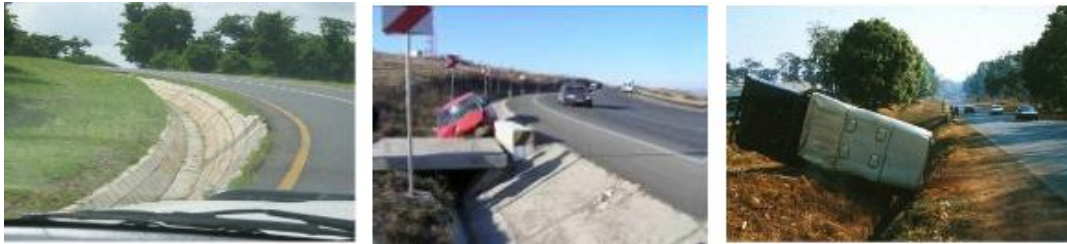
Figura 13. Sisteme periculoase colectare a apelor pluviale
