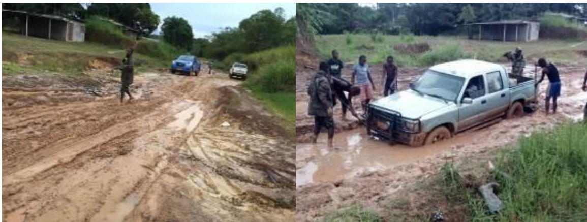
Photo 12- Vues des parties de la route principale de Bambouchine en très mauvais état
