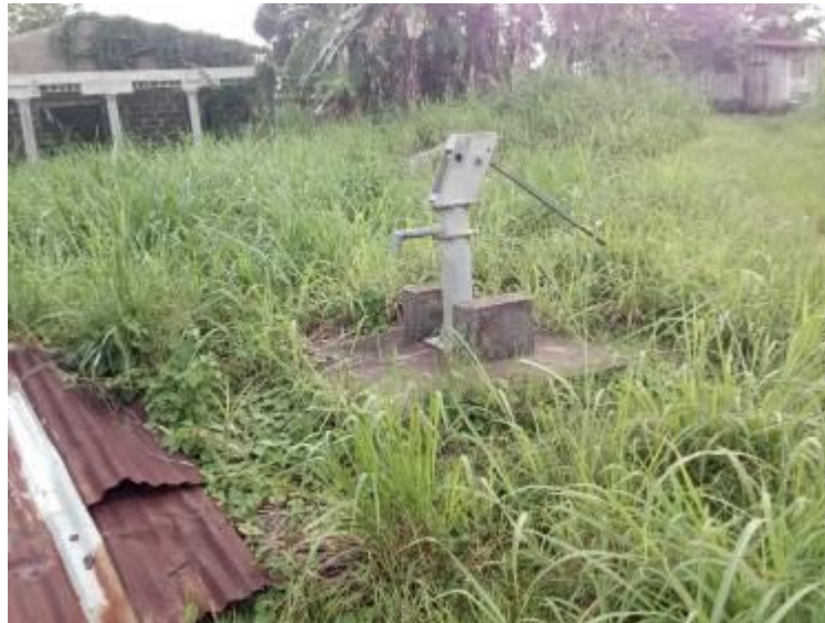
Photo 8- Vues de la pompe hydraulique à motricité humaine abandonnée de Mabosso
