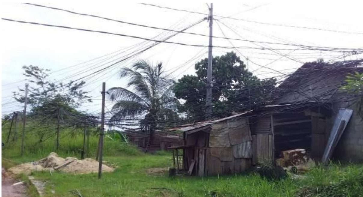
Photo 4-Installation anarchique et non conforme de ligne BT sur un axe
