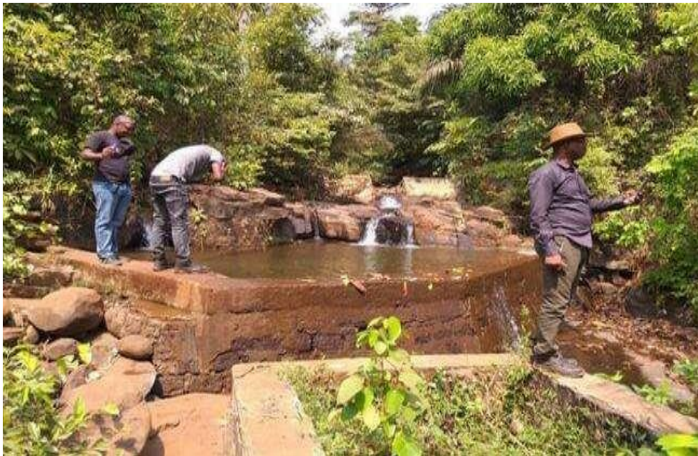
Figure 3 : Seuil (derrière) et regard pour vanne et ventouse (devant)
