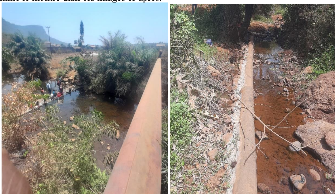
Figure 7 : traversée de conduite sur un cours d'eau (à gauche) et conduites longeant un cours d'eau (à gauche)
