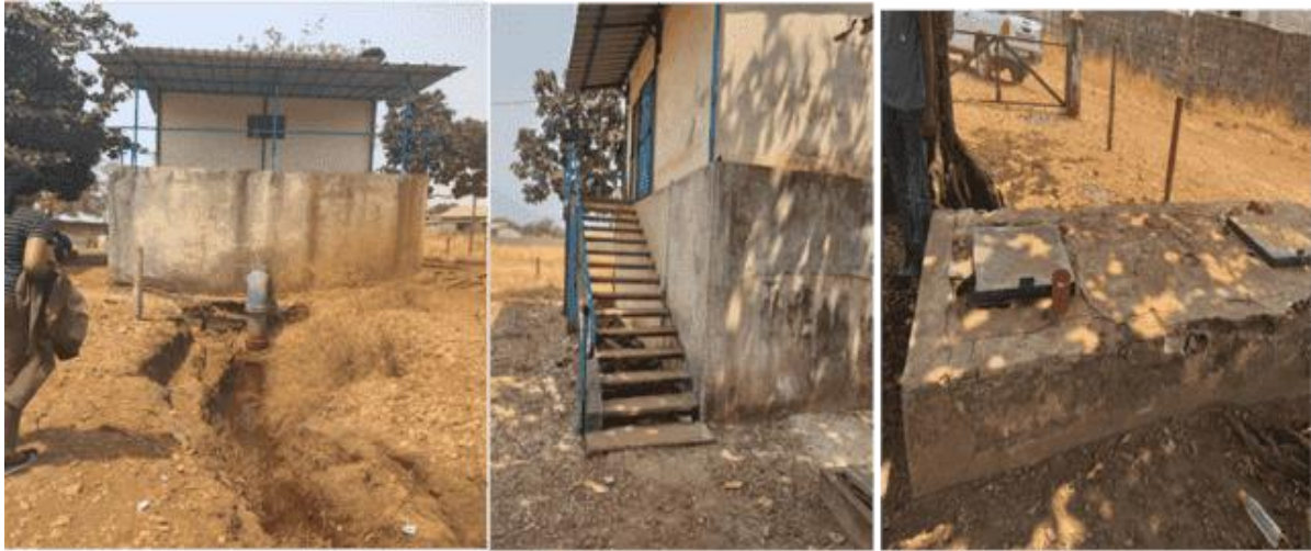
Figure 5 : Usine de traitement avec la conduite d'arrivée (à gauche) et Regard du compteur DN 150 mm sur la conduite de départ
