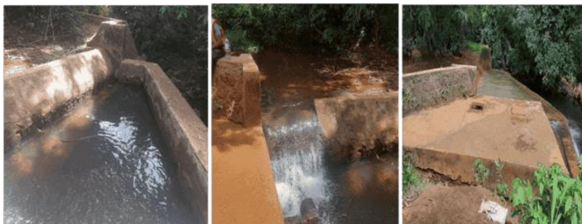
Fig. 4 : Seuil (à gauche), déversoir (au centre) et chambres d'admission/décantation (à droite)
