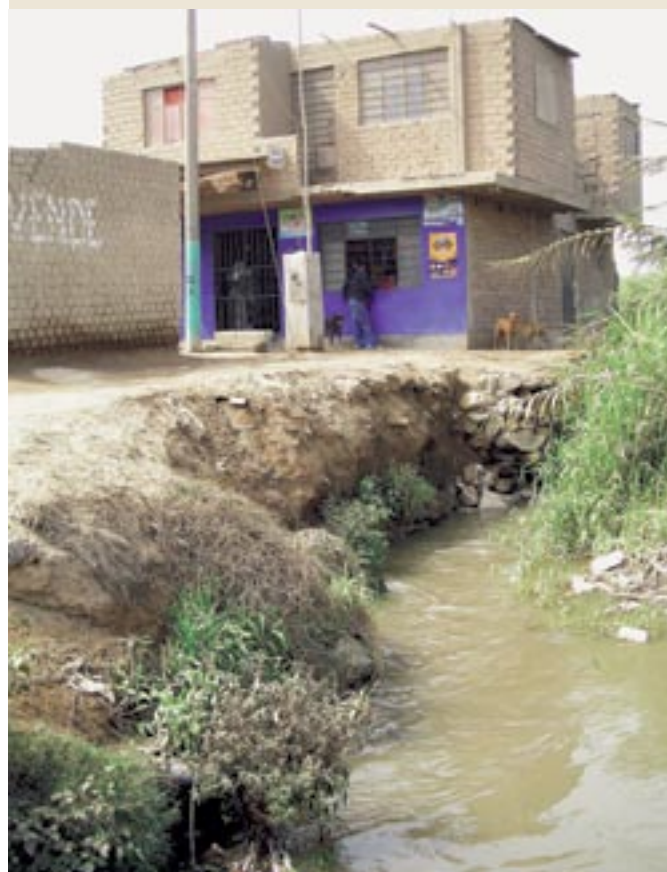
Foto 5: Canal de regadío
