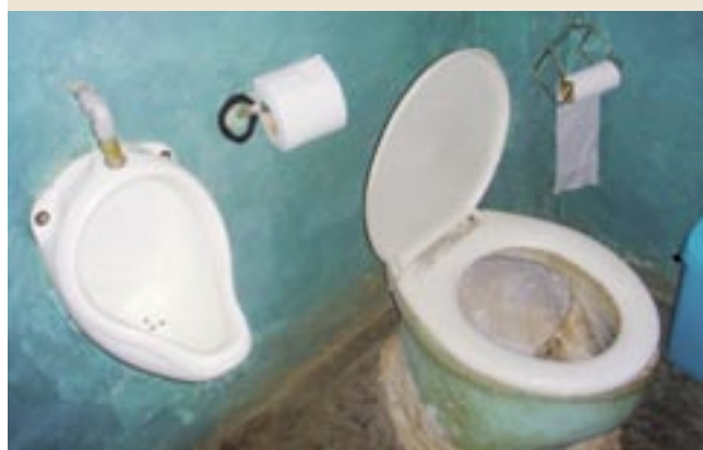
Foto 2: “Eco-inodoro” instalado en un proyecto piloto de Lima
