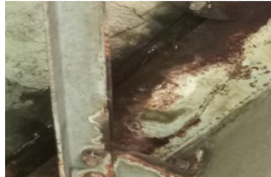
2. Corrosion des éléments de la poutrelle d'un viaduc
