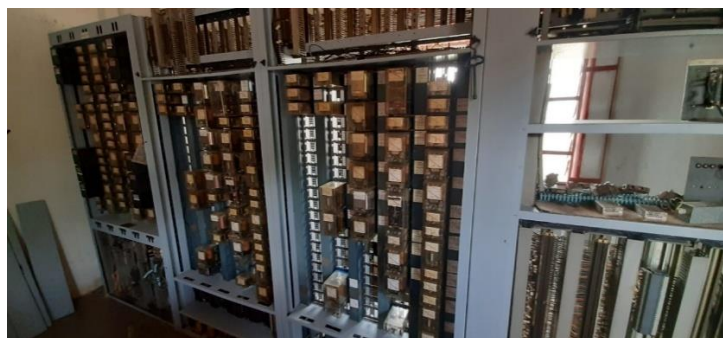
Photo 32: Disposition des châssis des relais d'enclenchement dans la salle d'appareillage
