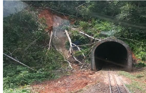
4. Éboulement de talus à la sortie d'un tunnel
