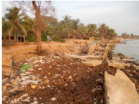
Vue en direction du Sud de la partie sud de la plage de l'Hôtel Le Savana. La plage sableuse a complètement disparu et même la promenade de haut de plage a été démolie au cours des tempêtes qui se sont succédées ces dernières années.
