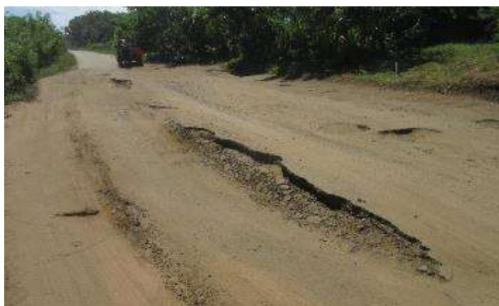
Figure 3 : Etat actuel de la chaussée du PK 11+000 au PK 31+000
