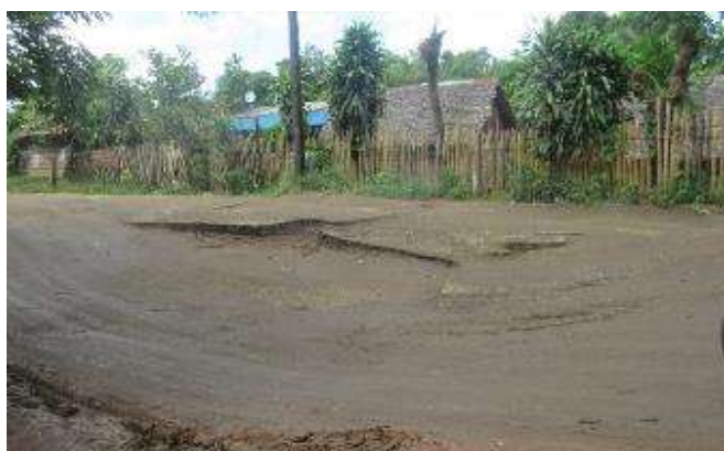
Figure 2 : Etat actuel de la chaussée du PK 7+000 au PK 9+000
