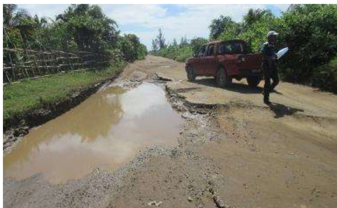
Figure 4 : Etat de dégradation de la chaussée
