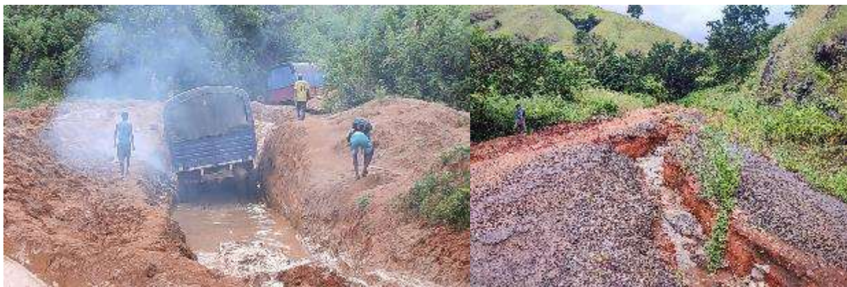
Photo 2. Aperçu de l'état actuel de la route – entre mars et avril 2023
