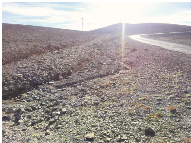
Figure 73 : Absence de fossés au PK 10
