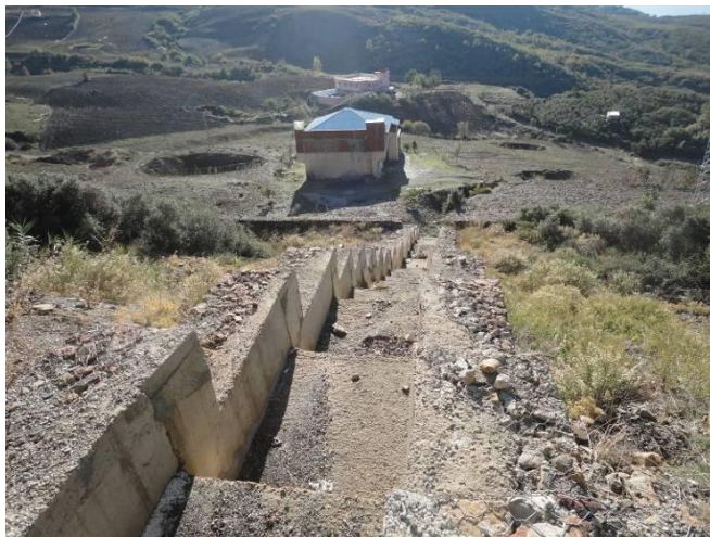
Figure 17 : Absence de protections en pied de chute au PK 156+200
