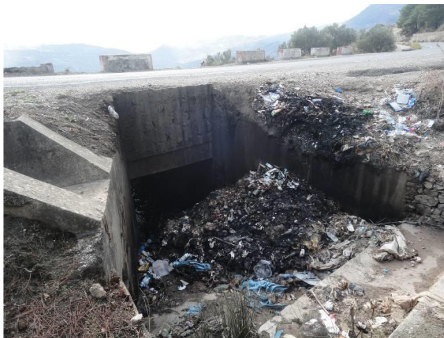
Figure 16 : Dépôts solides à l'entrée de l'OH au PK 148+700
