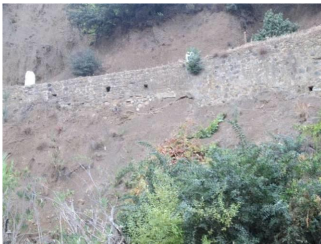
Figure 66 : Mur perché suite au sapement de l'oued (PK80+500)
