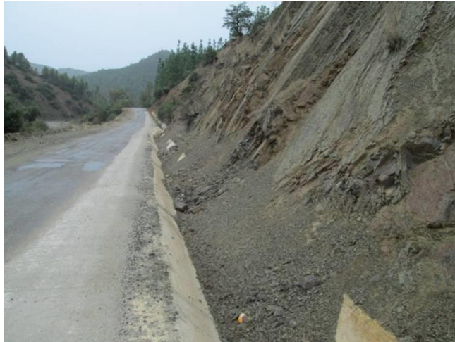
Figure 186 : Erosion du talus de déblai au PK 84+000 de la RR 508
