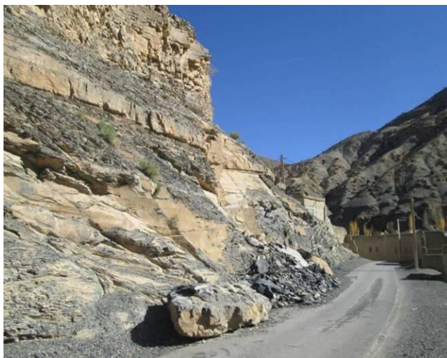
Figure 85 : Blocs écroulés (PK43+100)
