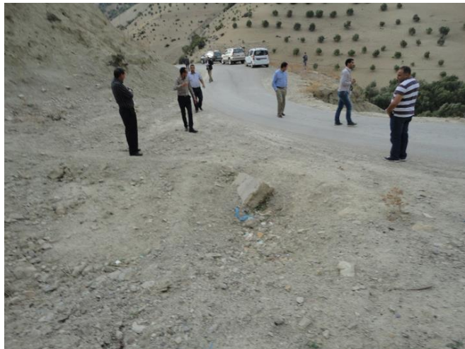
Figure 47 : OH colmaté au PK 50+600
