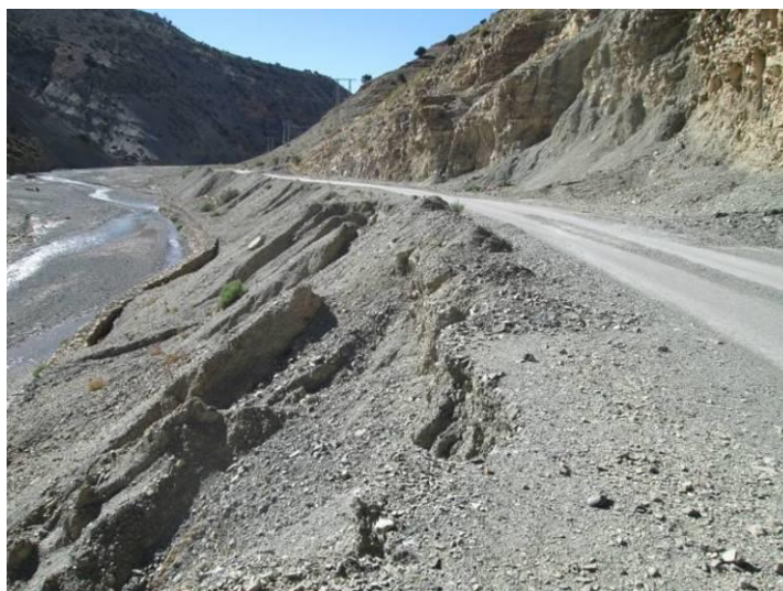
Figure 86 : Glissement de talus (PK47+700)
