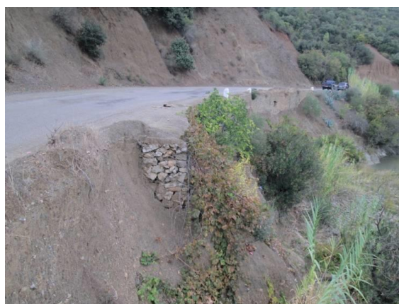
Figure 59 : Sapement de pied et effondrement de gabion (PK80+500)
