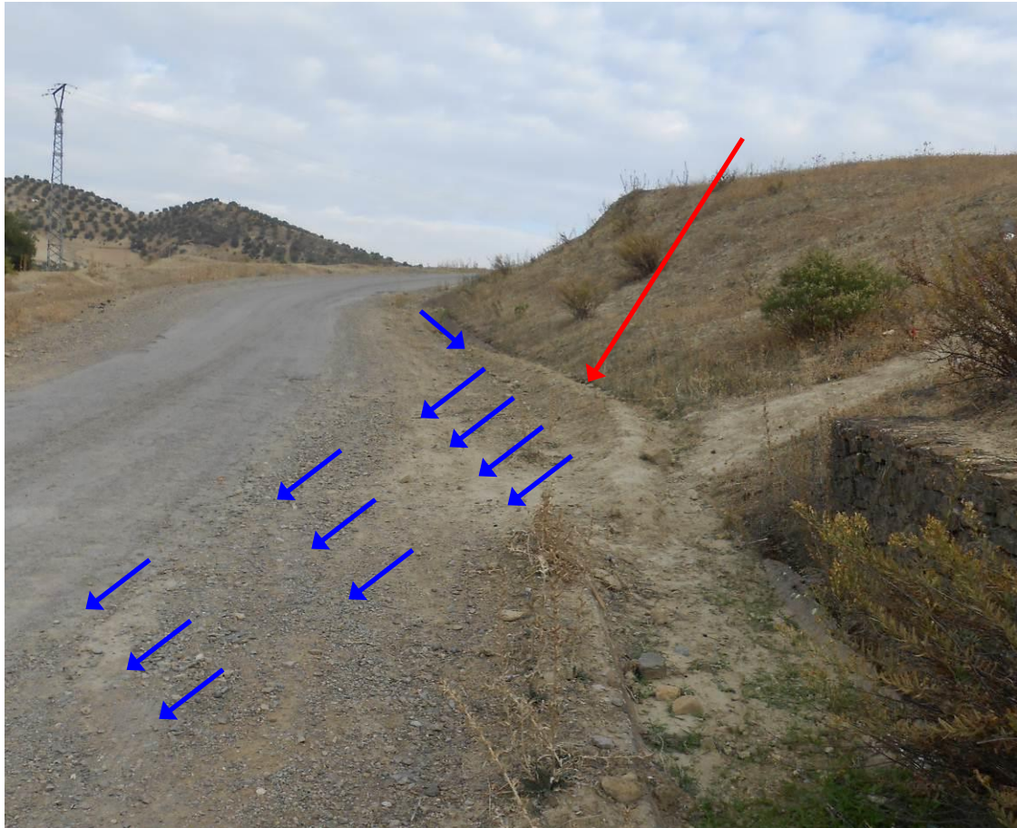
Figure 157 : Exemple d'un fossé colmaté (flèche rouge) générant des débordements sur la route (flèches bleues) lesquels sont la cause d'érosion du talus de remblai.
