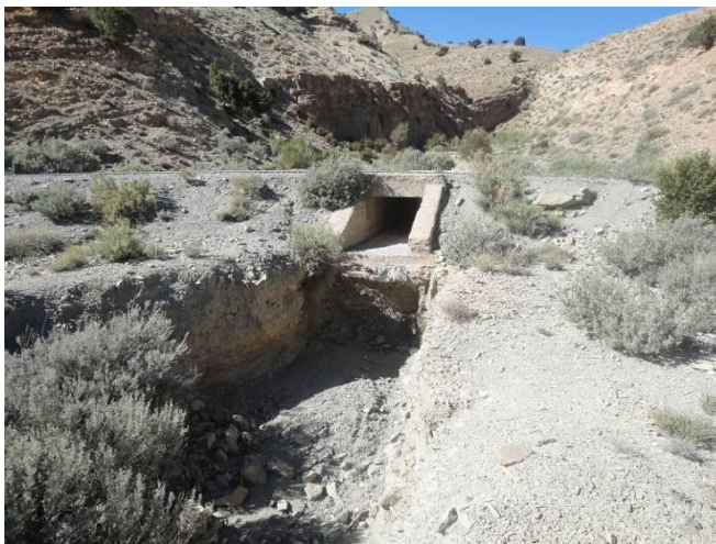
Figure 80 : Absence de protection en aval de l'OH au PK 60
