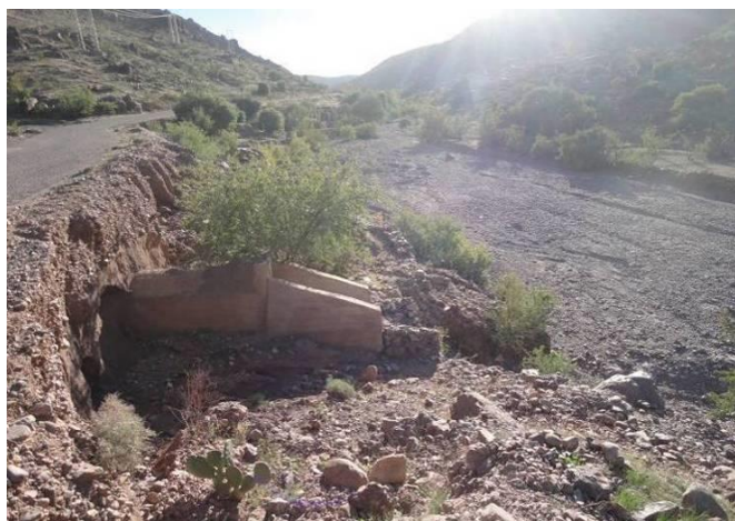
Figure 98 : Dégâts de crue au PK 96+970
