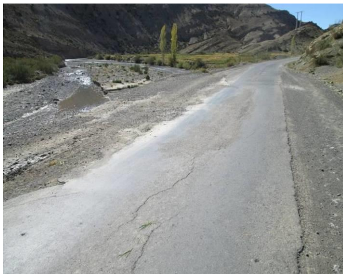
Figure 87 : Fissuration et affaissement de la chaussée côté oued (PK62+500)
