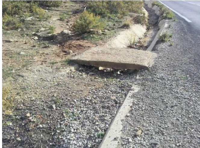
Figure 19 : Colmatage du fossé au PK 145
