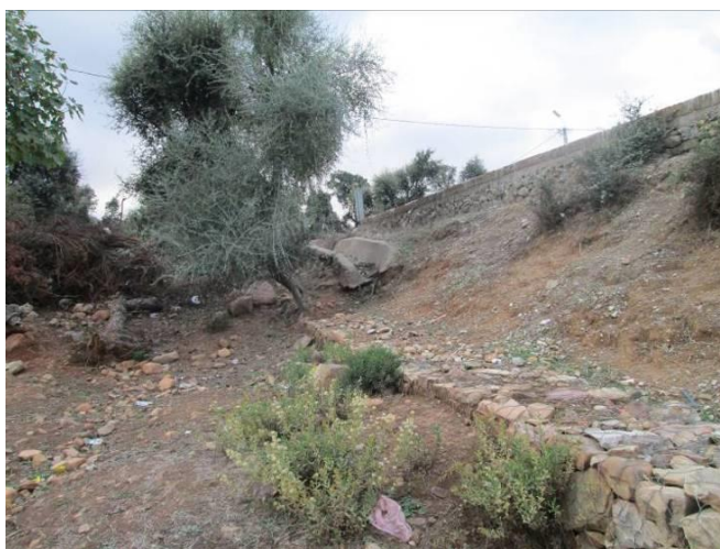
Figure 18 : Absence de protections au rejet du fossé au PK 124
