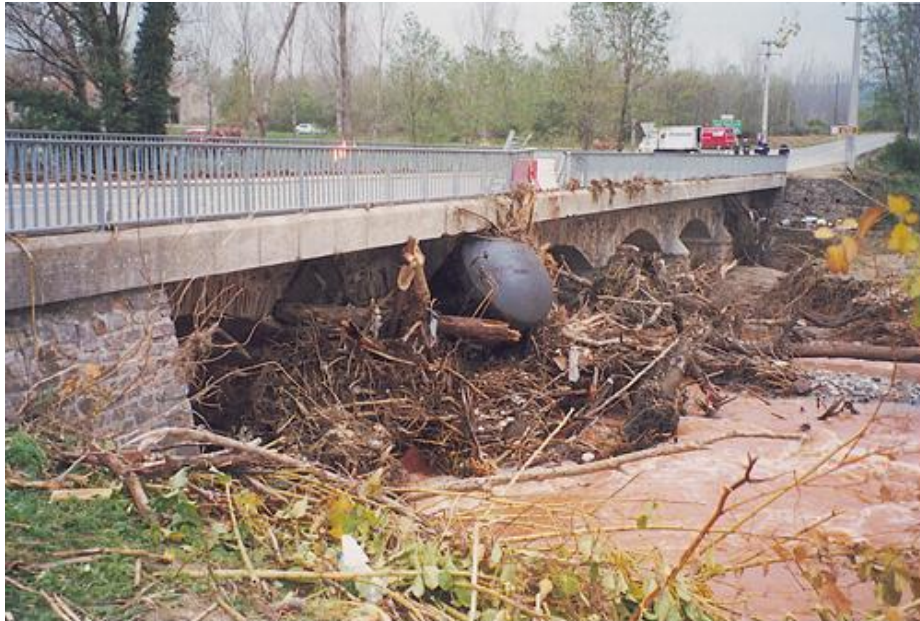
Figure 122 : Exemple d'embâcle au droit d'un pont
