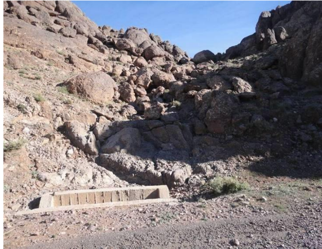
Figure 99 : Absence de captage amont au PK 93+270
