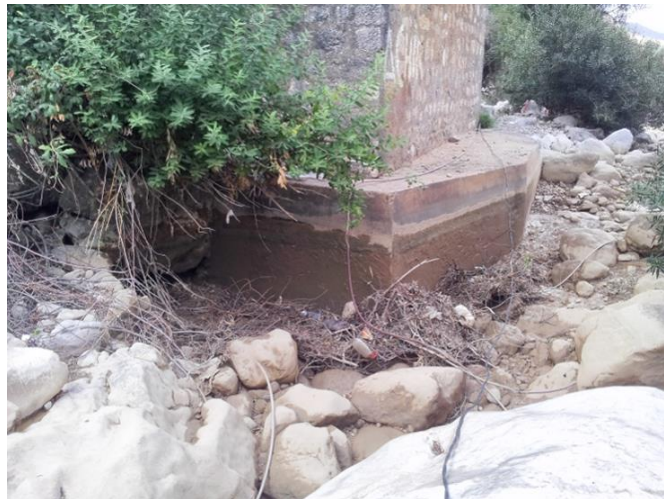
Figure 20 : Affouillement au droit de la culée de l'oued Ametras
