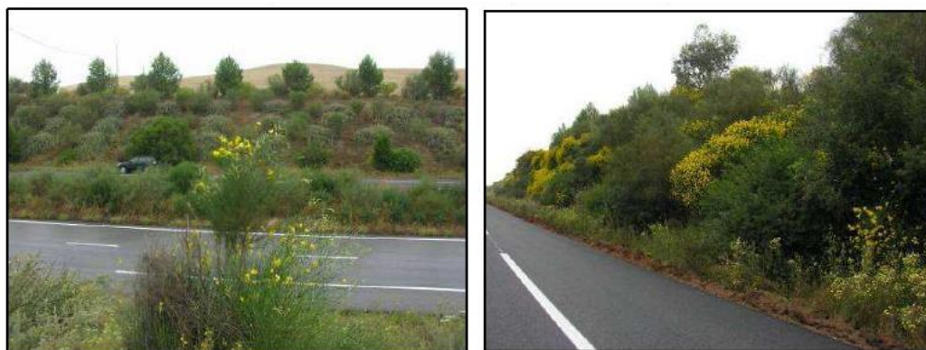
Etat des talus et TPC du site de l'oued El Kell 12 ans après
