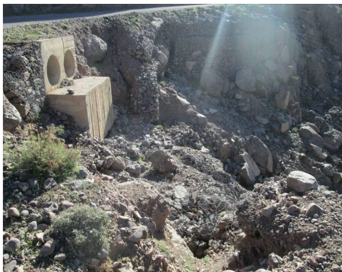
Figure 110 : Mur de soutènement en gabion démoli -PK 93+270
