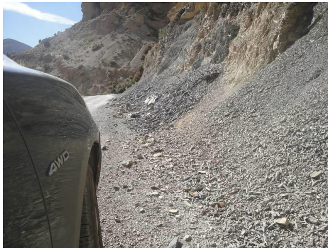
Figure 187 : Erosion du talus de déblai au PK 50+300 de la RR 706
