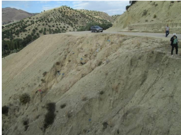
Figure 63 : Erosion du talus de remblai (PK50+600)
