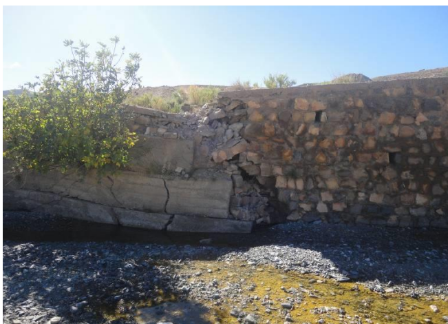
Figure 79 : Dégradation de la zone d'about du RS au PK 85
