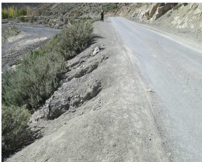
Figure 88 : Erosion de talus de remblai (PK65+500)
