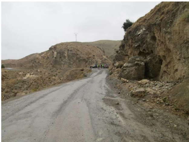
Figure 179 : Instabilité rocheuse au PK 104+800 de la RR 508
