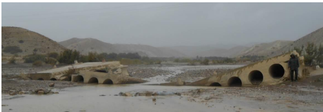
Figure 117 : Exemple de destruction d'un radier busé après une crue
