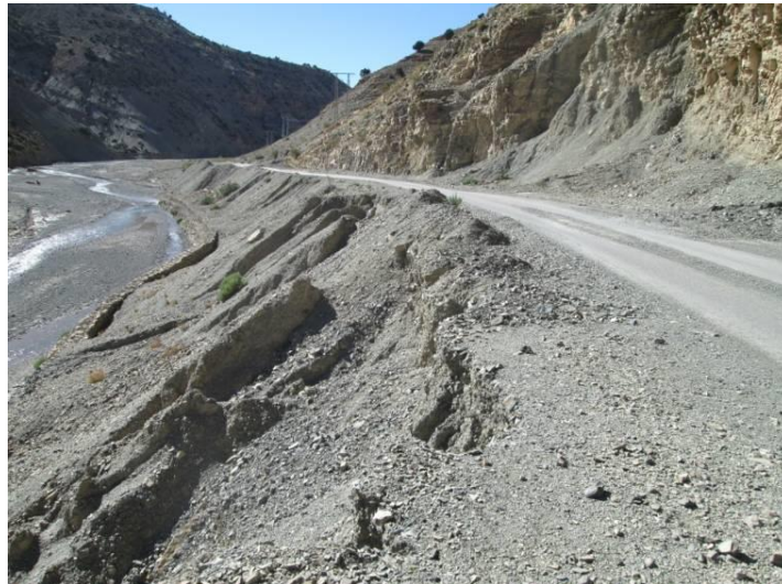
Figure 161 : Glissement de terrain au PK 47+700 de la RR 706
