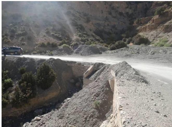
Figure 75 : Débordement des eaux au PK 49+500
