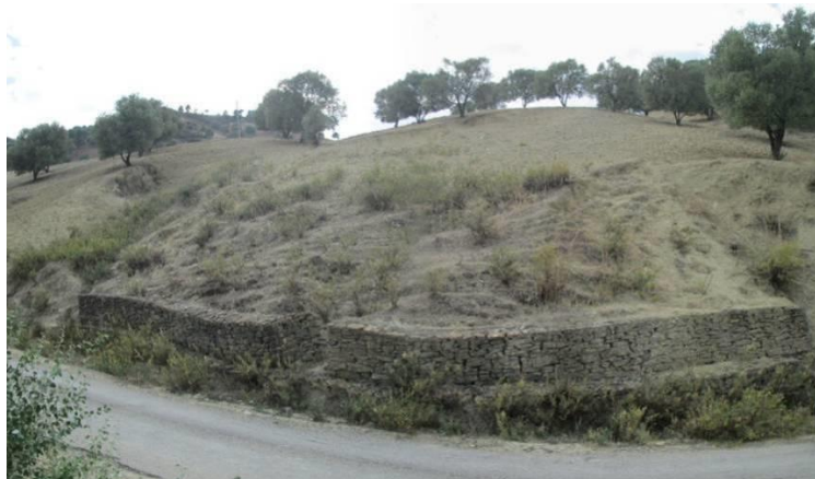
Figure 57 : Glissement de talus de déblai (PK55+400)
