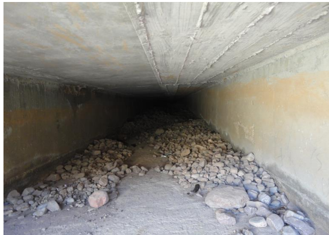
Figure 100 : Colmatage de l'entrée de l'OH au PK 96+970
