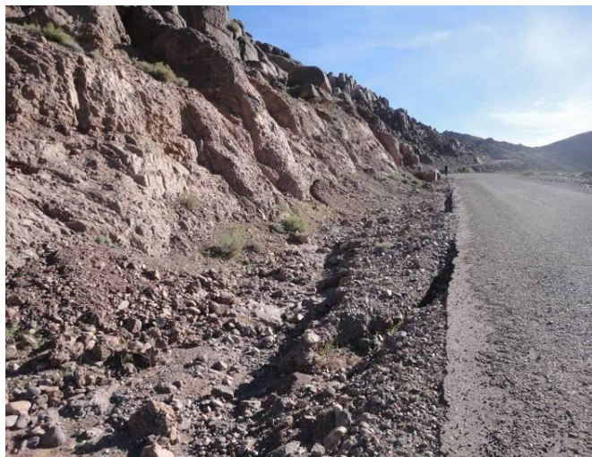
Figure 97 : Absence de fossés au PK 94+500
