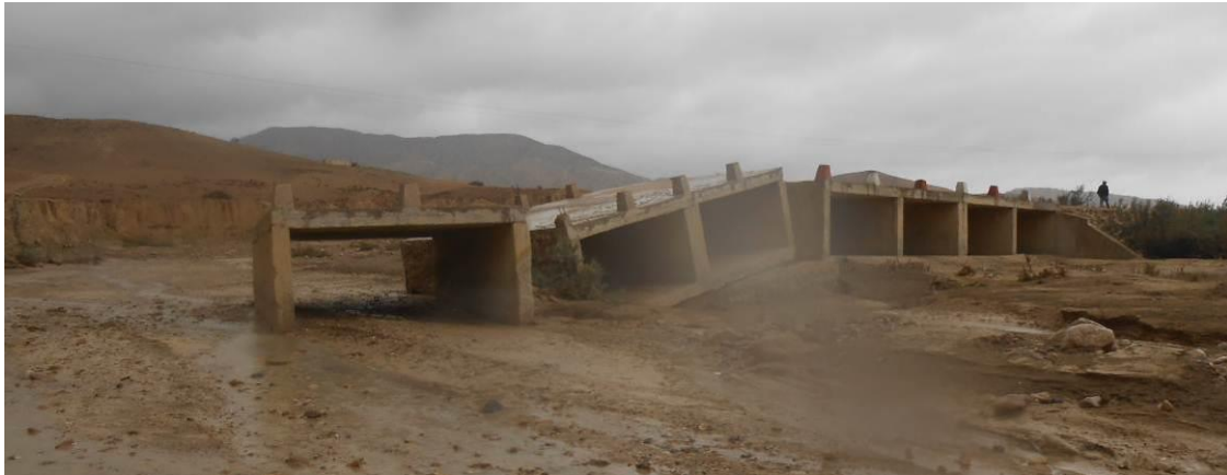
Figure 118 : Exemple de destruction d'un pont submersible après une crue
