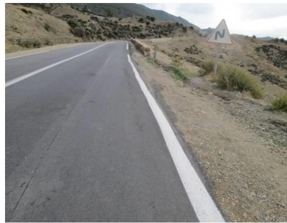
Figure 27 : Fissures longitudinales de la chaussée (PK133+800)
