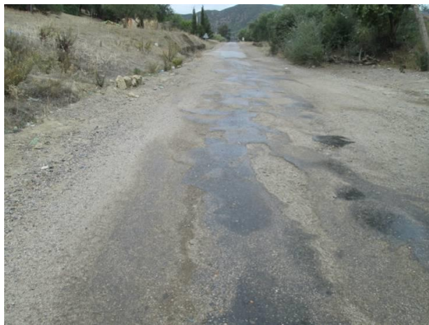
Figure 64 : Chaussée dégradée (PK77+800)
