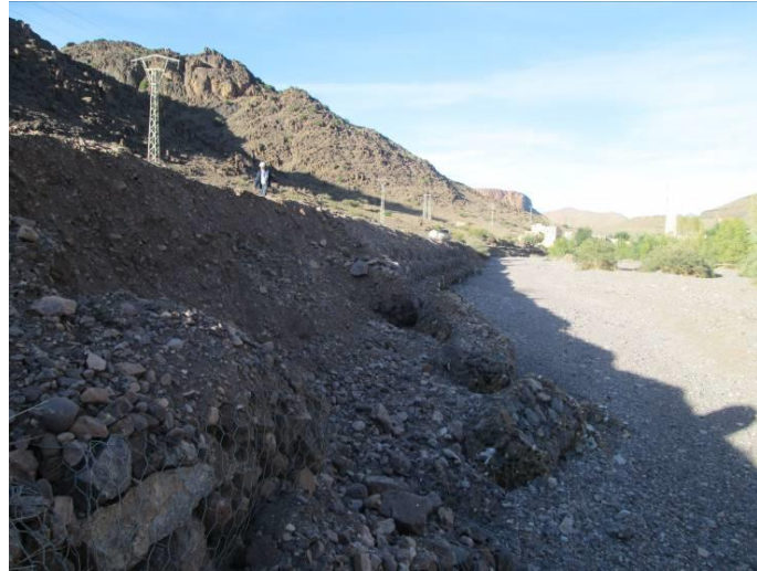
Figure 108 : Mur en gabion détruit - PK102+200
