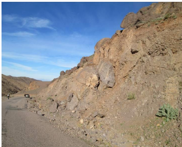
Figure 181 : Zone d'éboulement au PK 94+500 de la RR 106
