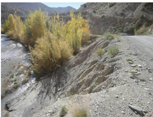
Figure 81 : Sapement des berges au PK 50+300
