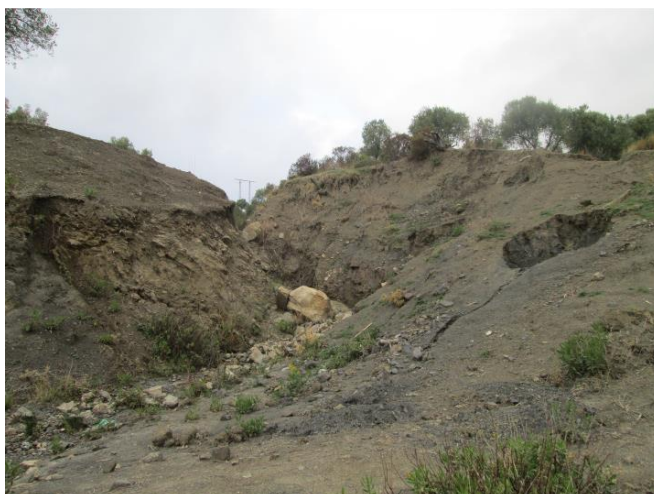
Figure 14 : Absence de captage de Chaâba au PK 128+800
