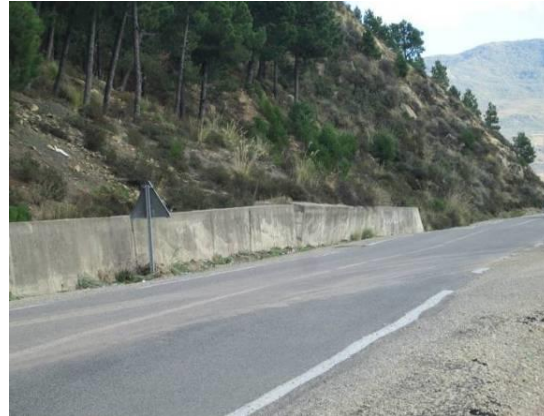
Figure 29 : Mur de soutènement incliné et affaissement de la chaussée (PK136+900)
