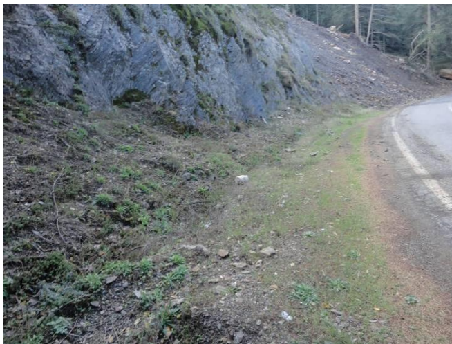
Figure 13 : Absence de drainage au PK 197+500
