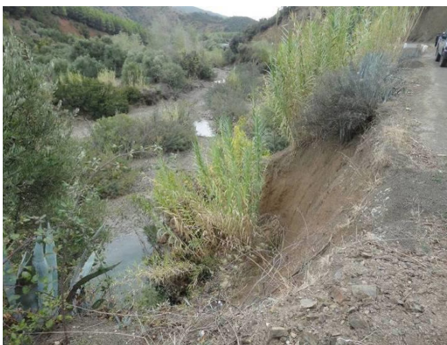
Figure 50 : Erosion du remblai au PK 80+500
