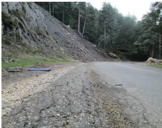
Figure 26 : Affaissement et fissuration de la chaussée (PK197+500)
