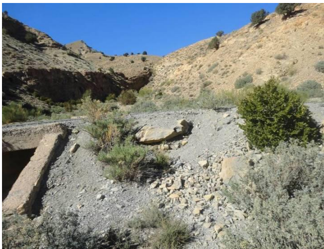
Figure 77 : Absence de protection du remblai au PK 60
