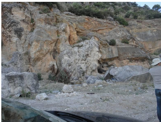
Figure 180 : Chute de blocs de pierre entre les PK 142+200 et 143+900 de la RN 2
