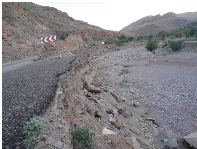
Figure 104 : Sapement des berges au PK 112+400
