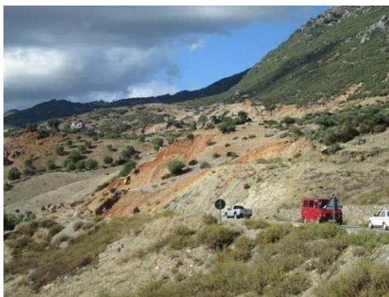
Figure 22 : Versant instable traversé par la route au PK 133+600
