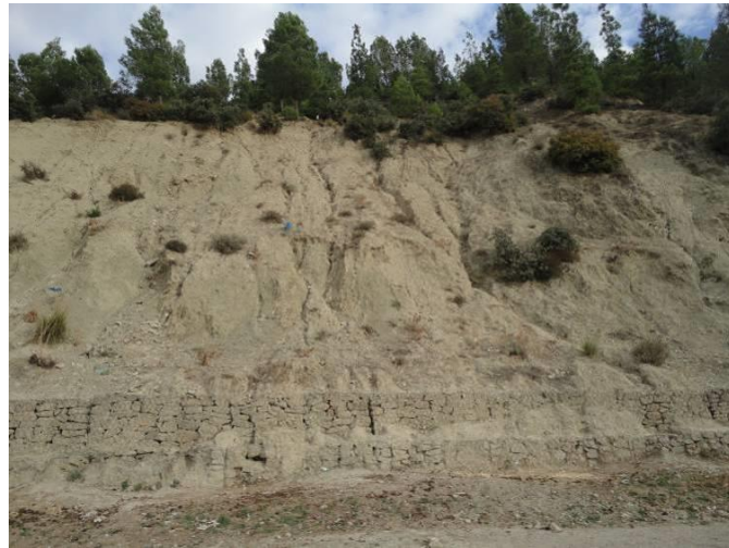
Figure 188 : Ravinelements du talus de déblai au PK 50+600 de la RR 508
