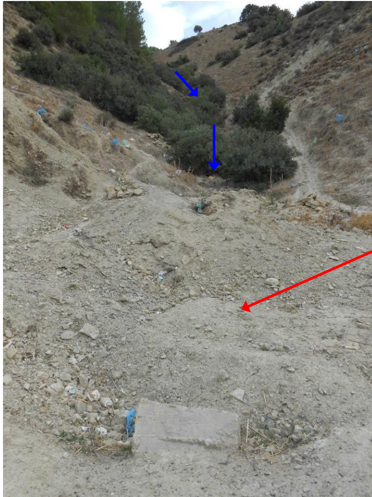
Figure 158 : Exemple d'une entrée d'un ouvrage de traversée sous chaussée colmaté (flèche rouge)
