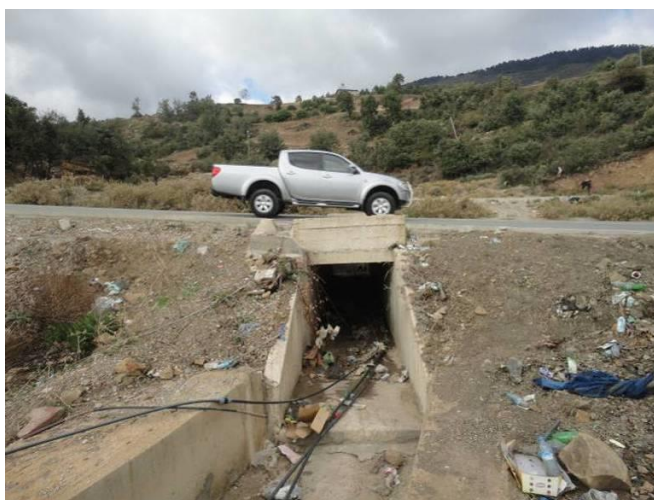
Figure 15 : Absence de protections du remblai au PK 161
