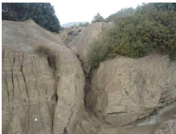
Figure 45 : Absence de captage au PK 117+882
