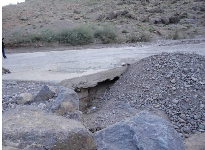
Figure 105 : Absence de protections contre l'affouillement au PK 106+400
