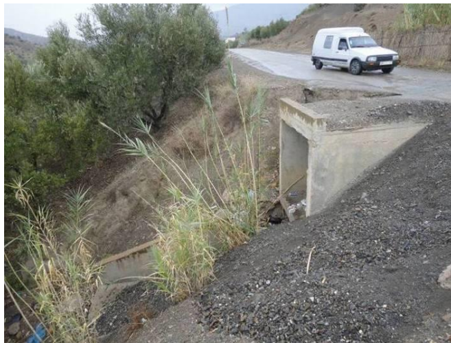
Figure 48 : Absence de protections du remblai au PK 96+600
