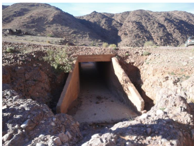
Figure 101 : Absence de protections du remblai au PK 95+970
