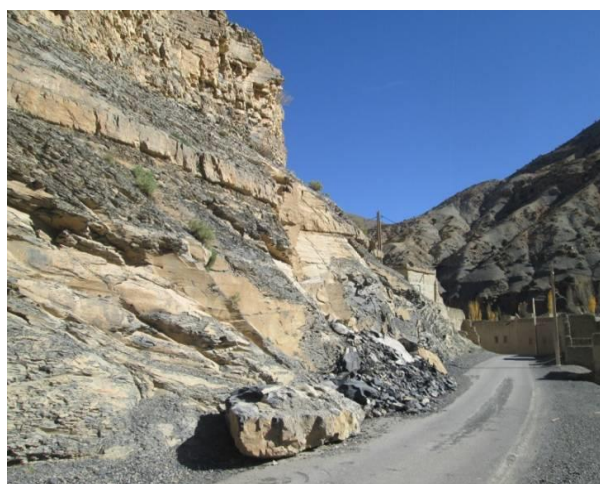
Figure 182 : Chute de pierre au PK 43+100 de la RR 706
