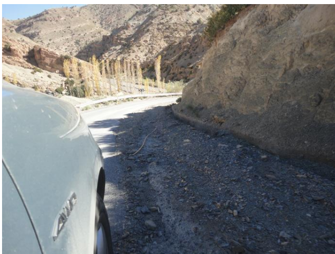
Figure 82 : Obturation de la section du fossé au PK 49+500
