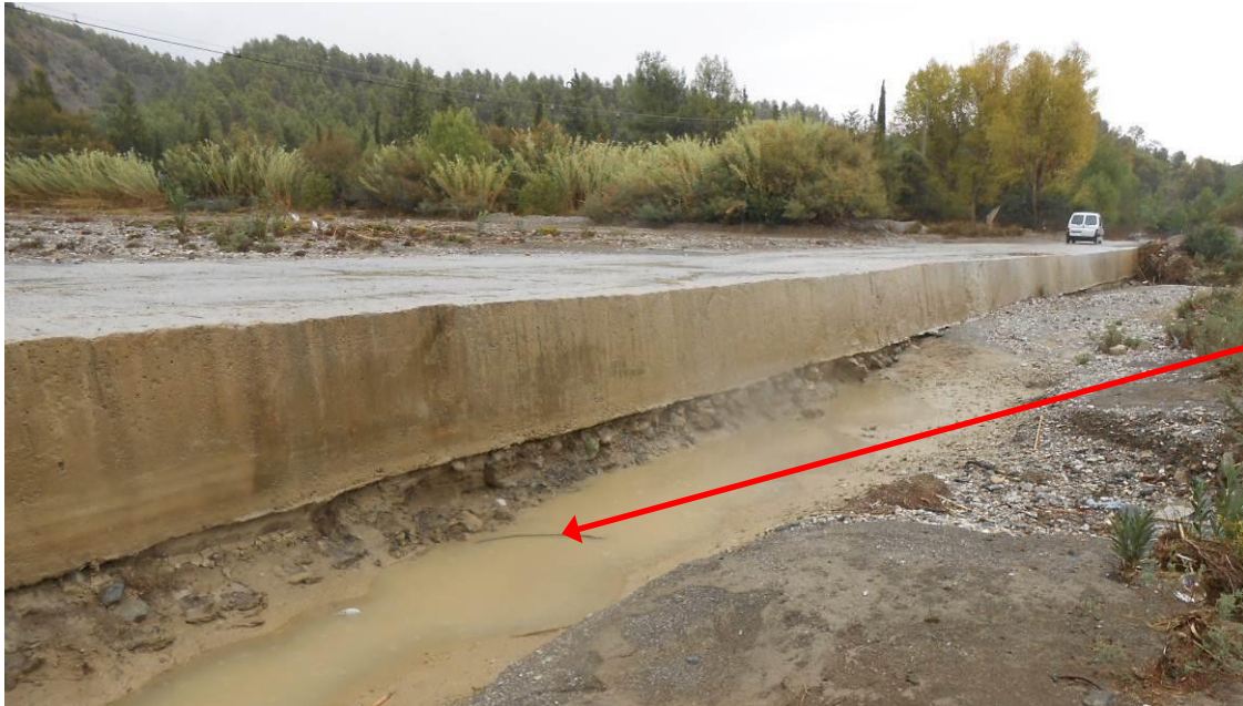
Figure 124 : Exemple d'affouillement en aval d'un radier béton au fond d'un oued : nécessité de mettre en place un dispositif anti-affouillement au niveau de la chute aval
