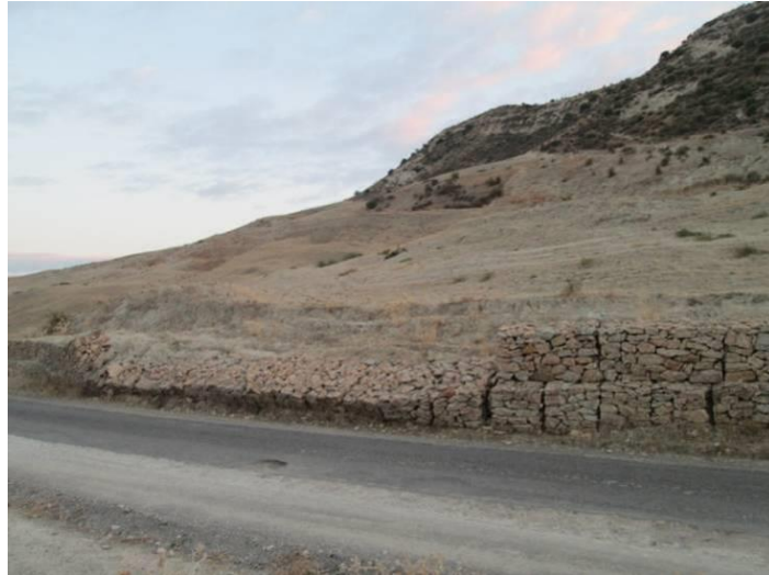
Figure 159 : Glissement de terrain au PK 21+557 de la RR508, avec mur de soutènement renversé
