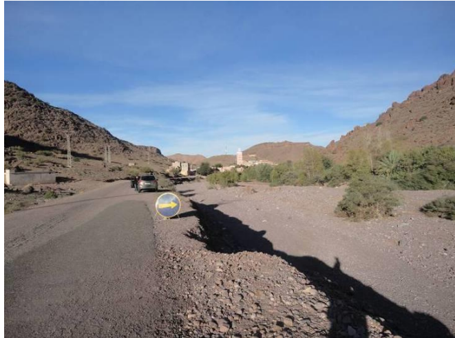
Figure 96 : Sapement du remblai de la RR 106 au PK 102+200
