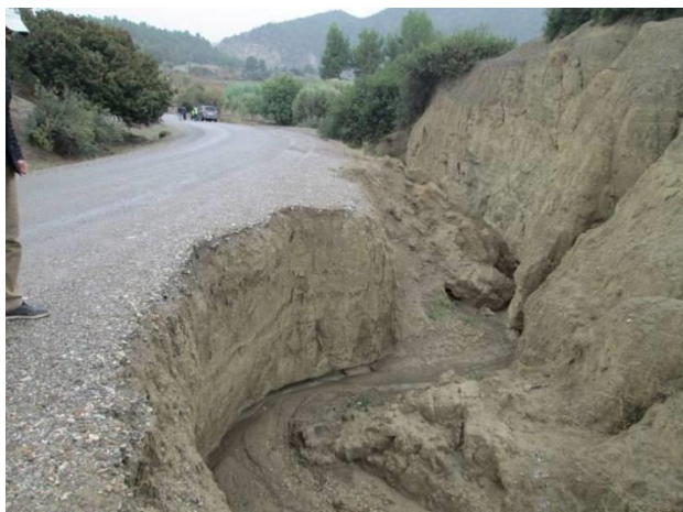
Figure 62 : Erosion de la fondation (PK117+882)
