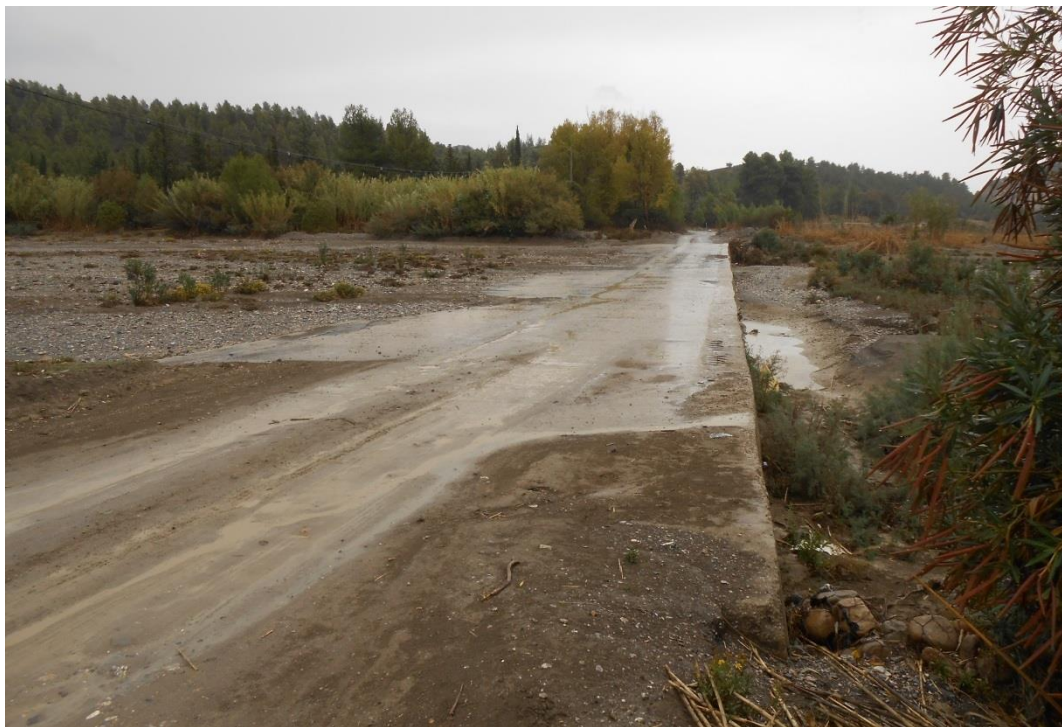
Figure 125 : RR508 PK 117+882 : exemple de radier submersible sans balises latérales et panneaux de signalisation
