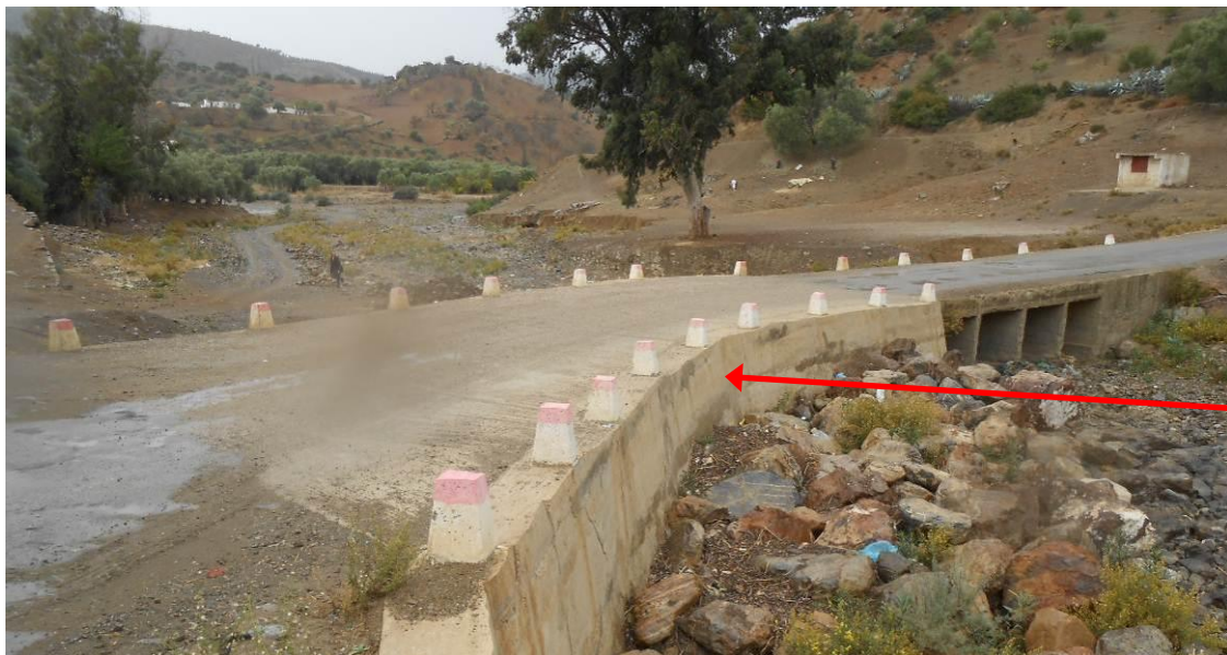
Figure 116 : Exemple d'un remblai d'accès au pont submersible emporté par les crues et reconstruit après la crue
