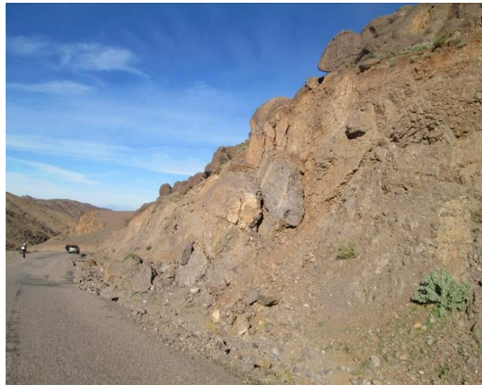
Figure 107 : Zone d'éboulement PK94+500
