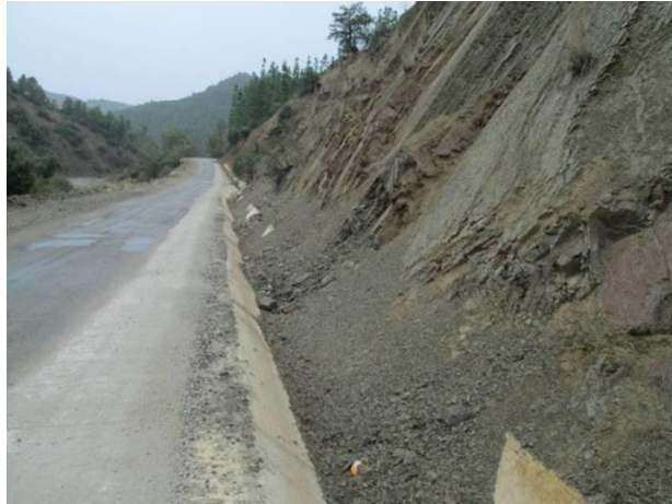
Figure 60 : Fossé rempli de matériaux d'érosion (PK84)
