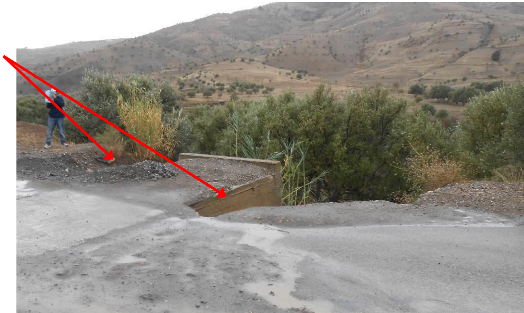
Figure 149 : Exemple d'un remblai partiellement emporté au droit d'un ouvrage hydraulique de traversée suite à la submersion de la route
