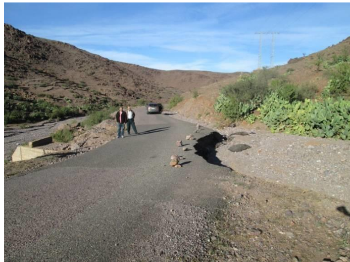
Figure 109 : Chaussée détruite à cause de colmatage de l'OH – PK97
