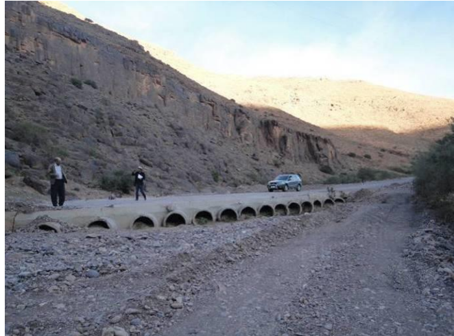
Figure 102 : Implantation problématique de la RR 106 et de l'OH au PK 106+400
