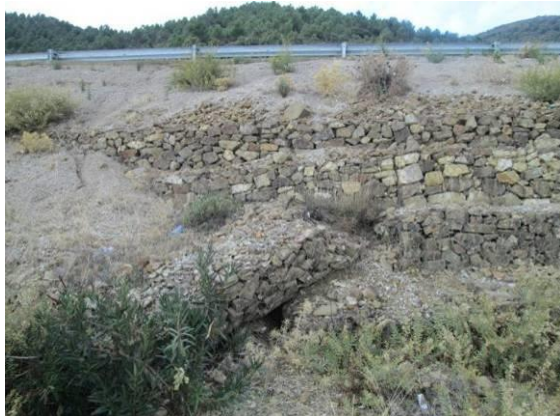
Figure 28 : Mur en gabion déformé (PK 164 – 165)
