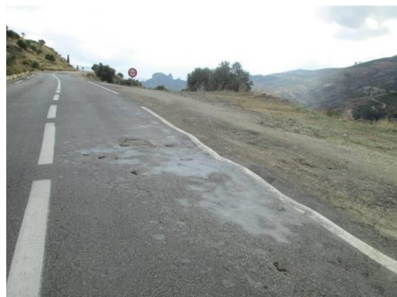
Figure 23 : Chaussée dégradée située dans l'emprise du glissement (PK 144+900 – 145+300)
