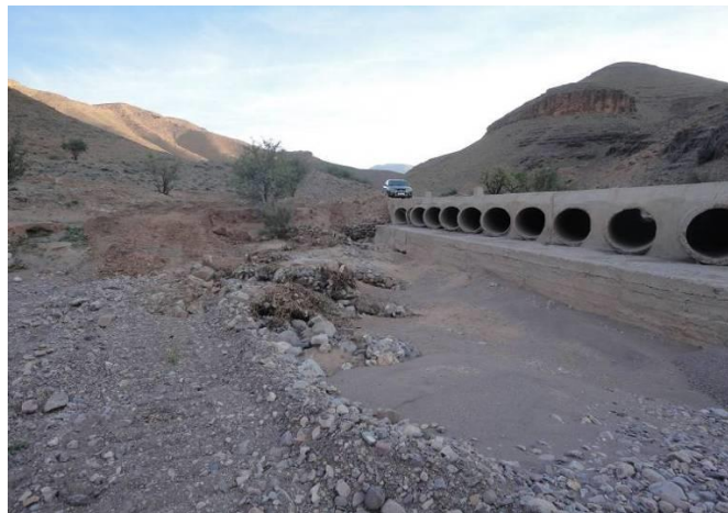
Figure 103 : Absence de protections en aval de l'OH au PK 109+600
