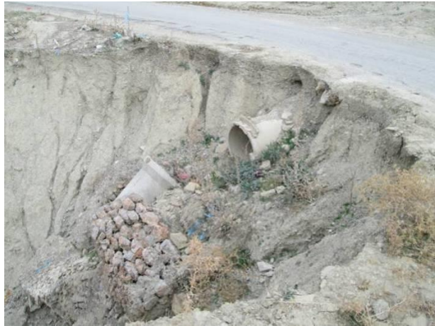
Figure 61 : Affouillement du remblai et départ de mur en gabion (PK50+600)
