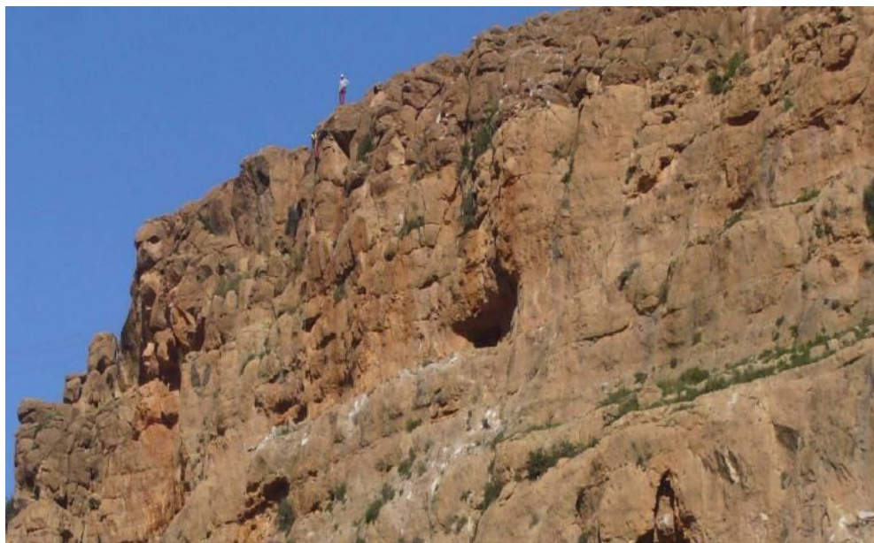
Figure 183 : Type de talus traité au sud du Maroc avec des filets et grillage
