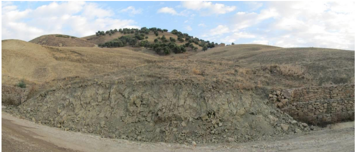
Figure 56 : Glissement de versant (PK37+800)
