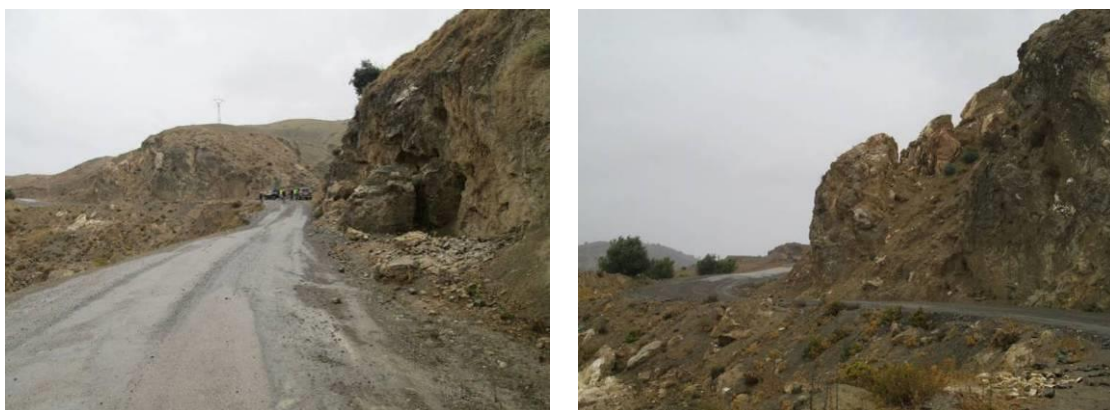
Figure 65 : Zone instable à risque d'écroulement (PK104+800)
