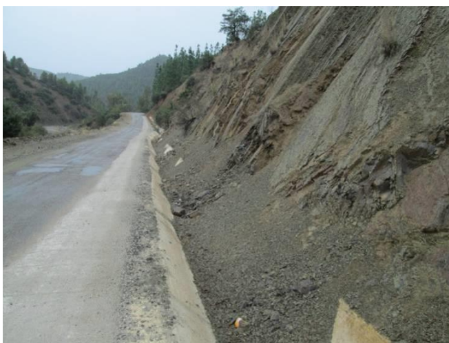
Figure 51 : Obturation de la section du fossé au PK 84+000
