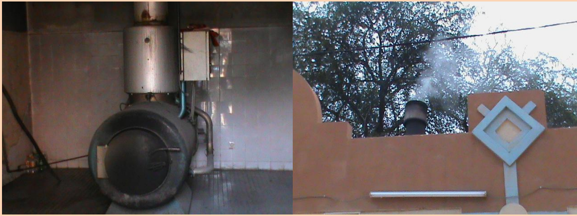
Photo 23 et 24 : Incinérateur de la Maternité Issaka Gazobi avec sa cheminée juste en dessous des fils de la Nigelec
