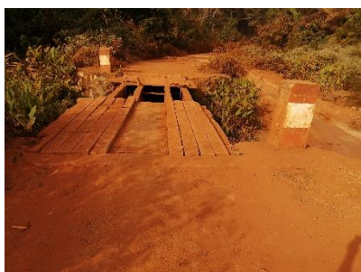
Photo 23: Dégradation du de la chaussée et des ouvrages de franchissement dans l'Arrondissement de Ntui
