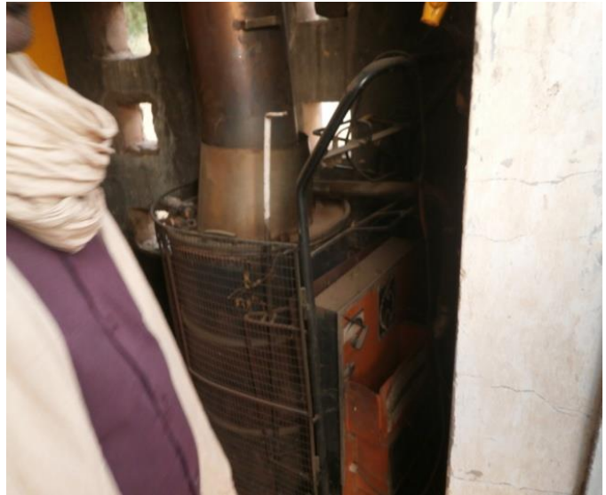
Incinérateur du service vétérinaire non fonctionnel
