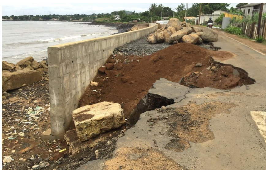
Figura 16: Estrada destruída por erosão pelo mar na zona costeira. Um muro de contenção está em construção para substituir o troço anterior (vestígios ainda visíveis) e proteger a estrada. Foto: Naraya Carrasco.
