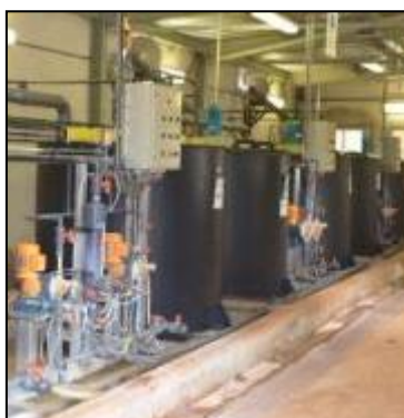
Figure 41: Usine d'eau potable attenante à la prise d'eau CBG
