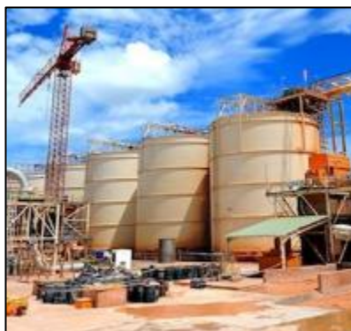
Figure 45: Cuves de lixiviation de l'usine SAG ou SEMFO
