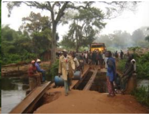
Pont Bouka cassé : passage d'un tonneau d'huile de palme sur les traverses
