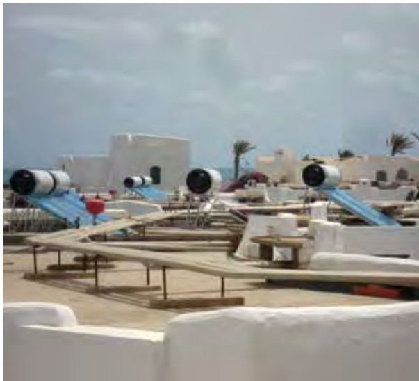
Chauffes eau solaire sur le toit d'un hôtel.
