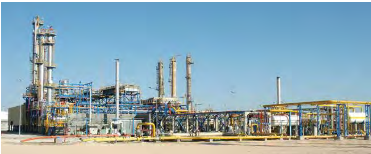
Usine de Gaz du pétrole liquéfié à Gabes.
