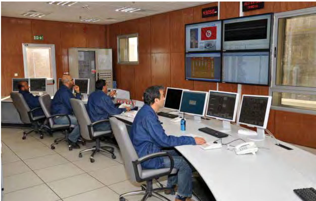
Salle de contrôle de la STEG à Ghannouch.
