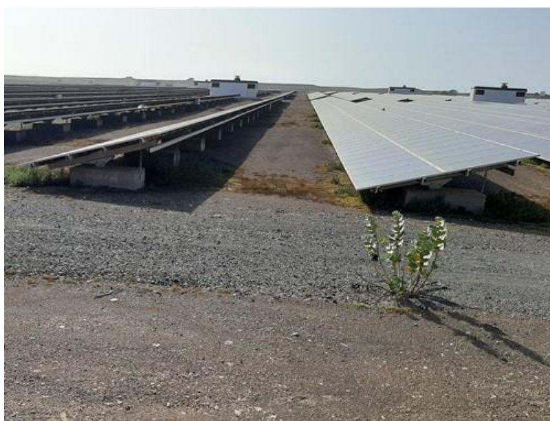
Figura 3 – Exemplo de painéis fotovoltaicos e respectiva estrutura de suporte; cabines de transformadores ao fundo (ilha do Sal)
