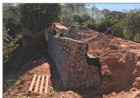
Figura 4: Implantação de contenção tipo gabião, Ocupação Rosa Leão (Fonte: CREURB, 2020)
