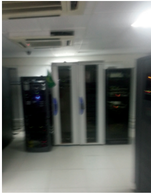
ARMOIRES DE SERVEURS COTES NORD
