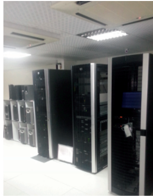
ARMOIRES DE SERVEURS COTES OUEST
