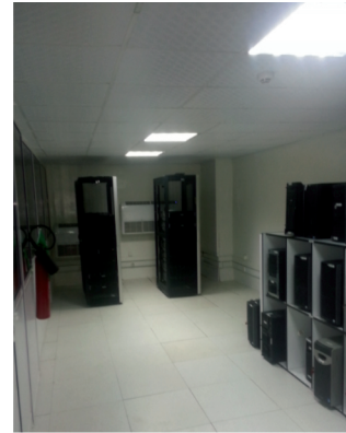
ARMOIRES DE SERVEURS COTES SUD
