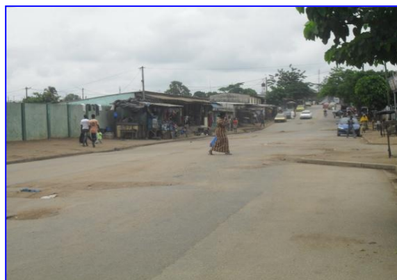
Photo 4 : Vue d'une zone de fortes dégradations de la chaussée de l'étage « cercueil » en amont au point bas au niveau de la station de relevage S7
