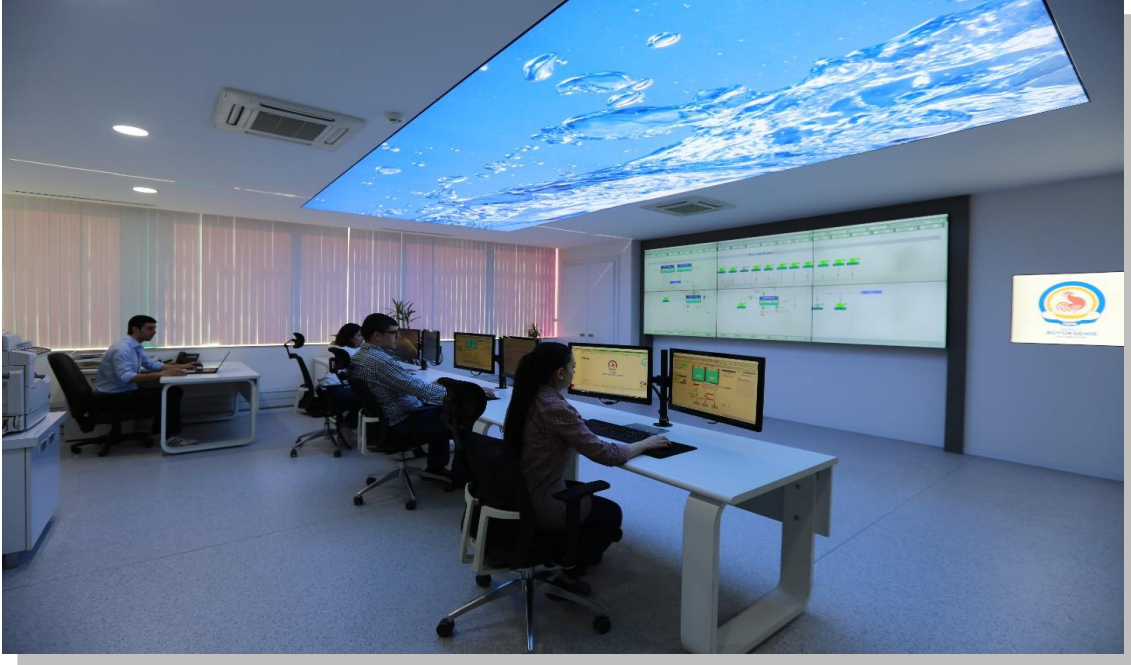
Şekil 5.1. DESKİ SCADA İzleme Merkezi
