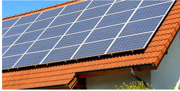
Panneaux solaires inclinés suivant le pan de toiture
