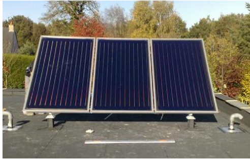
Panneaux solaires sur châssis
