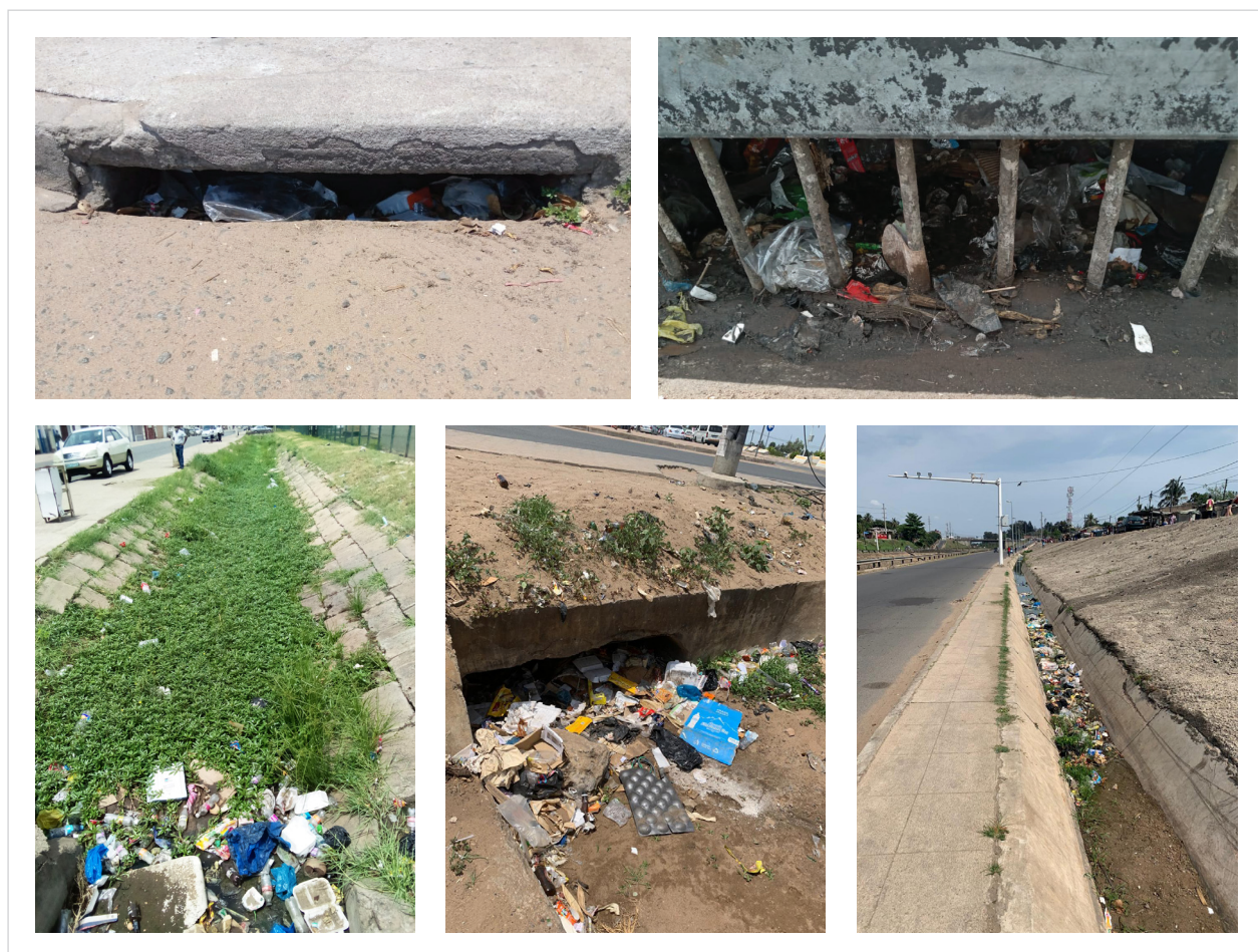
Figura 19 Evidências de fugas difusas involuntárias de resíduos plásticos em sistemas de drenagem enterrados e abertos (Baixa da Cidade, Av. Milagre Mabote, Av. Moçambique)
