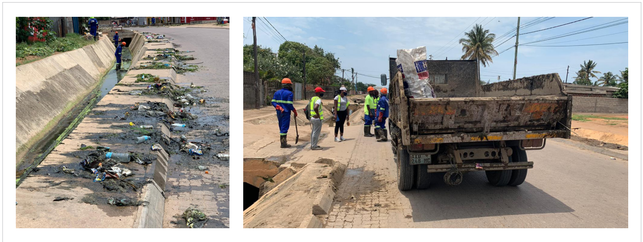
Figura 16 Situação dos escoadores de Lingamo e no bairro Dona Alice (Costa do Sol)
