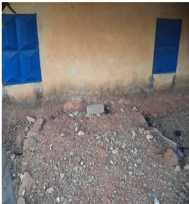
B5 : Traces d'inondation au niveau fenêtre d'un bâtis
