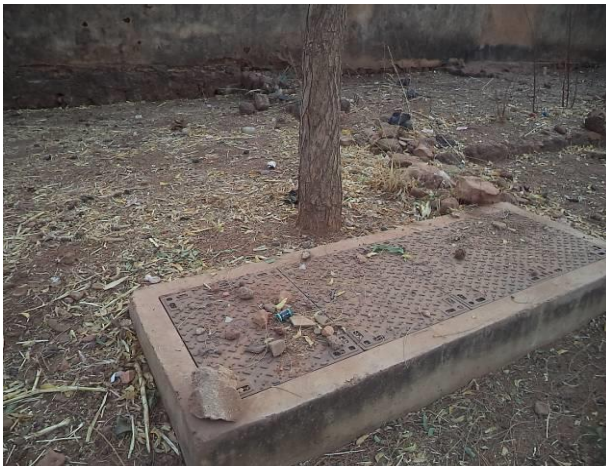
C4 : Chambre de TOGOTELECOM sur la RN24
