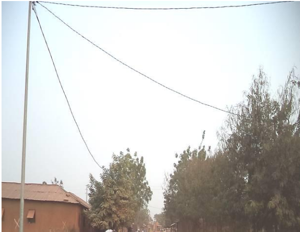
A4 : poteau, fils électriques et arbres sur la RN24
