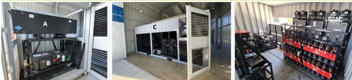
Figura 9-4 Principales componentes del banco de pruebas 118 . A) Pony Tank, B) Celda de Com-bustible, C) Zona abierta del contenedor, D) Sistema de baterías, E) Ventiladores de enfriamiento y F) Unidad de carga térmica (banco de resistencias para consumir la potencia generada)
