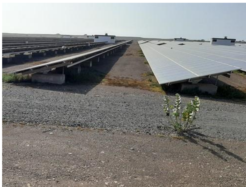
Foto 1 - Painéis solares fotovoltaicos e estrutura de suporte assentes em blocos de betão (Ilha do Sal)
