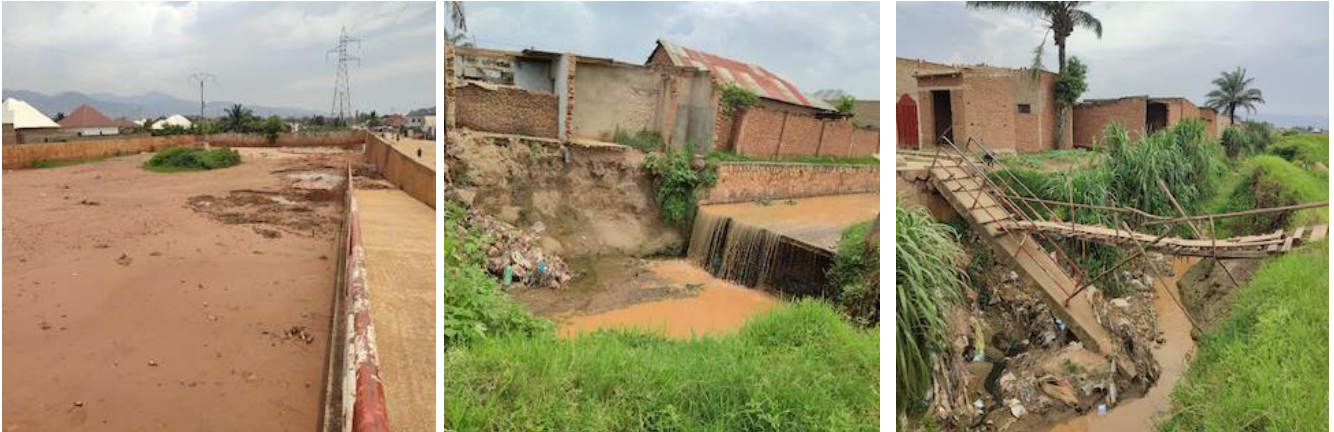
Photo 11 - Bassin de décantation et destruction de maisons et du ponceau à Buhinyuza (Kinama)
