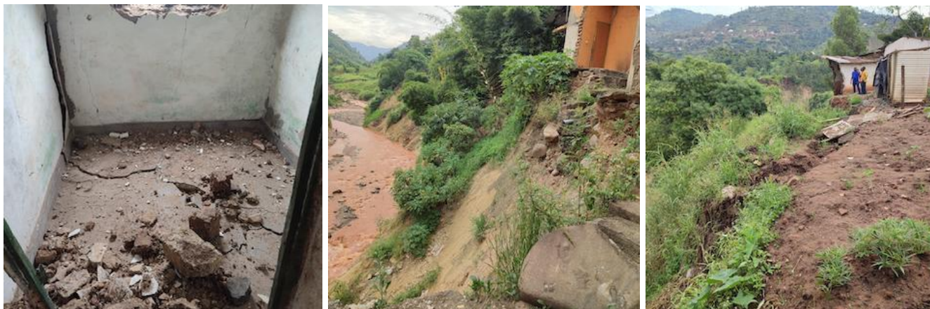
Photo 8 - Maison détruite par fissure (Bisekuro) et 2 autres par glissement des berges (Ntahangwa)
